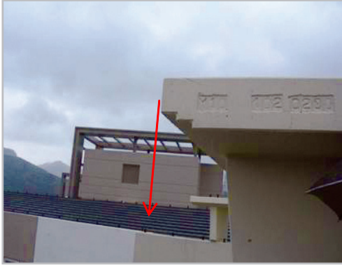
■ 옥상 장식구조물 경사도 처리 미흡 - 외부로 고드름 떨어질 우려
