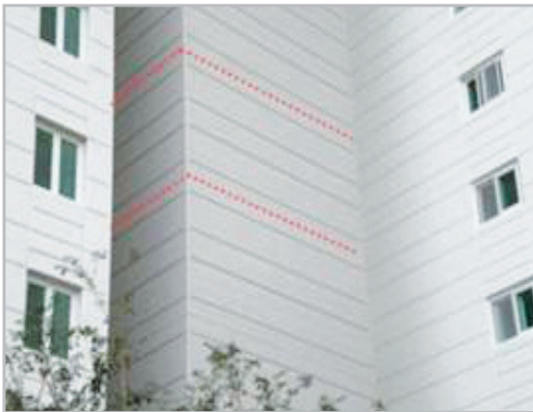
■ 벽면 시공 줄눈 부위 바탕 미관 저해
