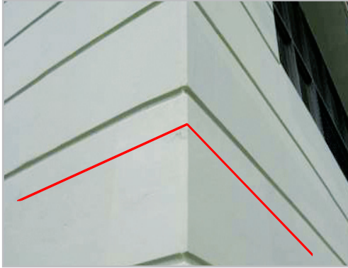
■ 옥탑 시공 줄눈(균열) 발생
