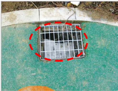
■ 어린이놀이터 트렌치 오픈형 커버로 안전사고 우려
