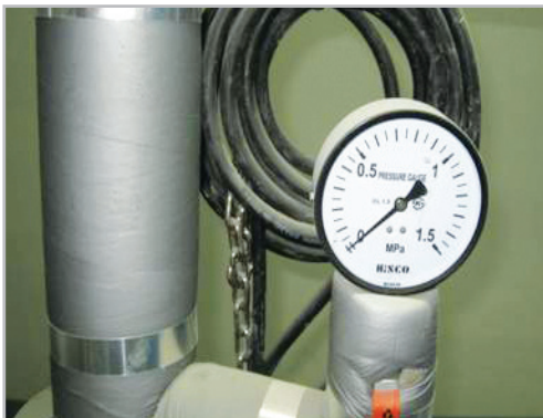
■ 배수펌프 압력계 양정 고려 미흡
