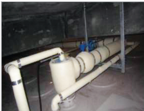
■ 지하저수조 상부 청소 미흡(오염)
