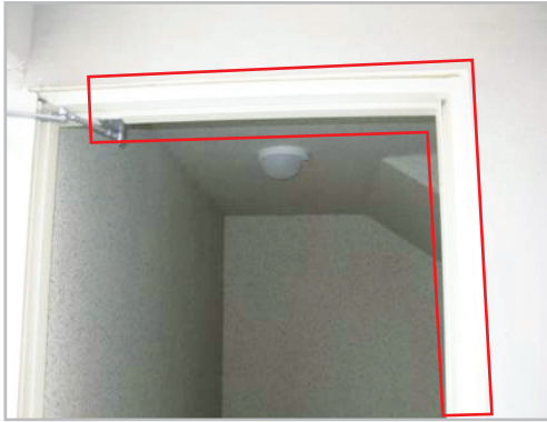
■ 계단실 출입문(방화문)틀 가스켓 누락
