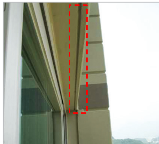
■ 창호 외부 상단 물끊기홈 설치 확인 - 대부분 발코니 확장 시공으로 외부 창호와 물 끊기홈 적정 간격 검토 필요
