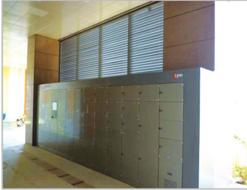
■ 필로티 내부 무인택배시스템 설치
