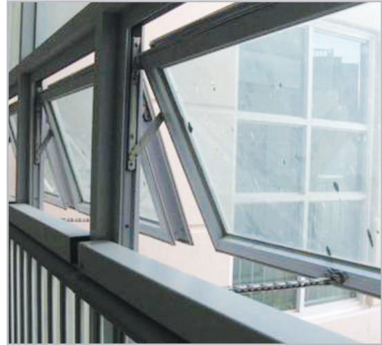
■ 세대 E/L홀 전동 배연창 설치로 채광 및 환기 유리
