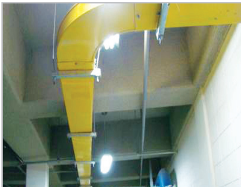
■ 지하주차장 특별고압인입덕트 “위험표지” 부착 미흡
