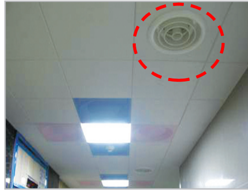
■ 지하E/L홀 급/배기환(전열교환기 연결) 설치로 결로 방지
