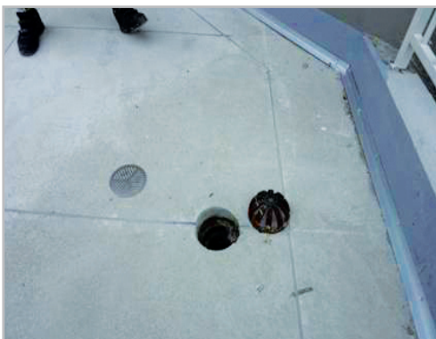
■ 옥상 바닥 배수 드레인 캡 매입형 시공으로 우수 침수(막힘) 우려
