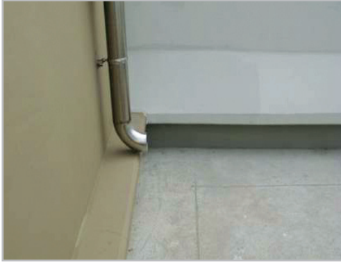
■ 옥탑 선홍통 하부 우수 처리 미흡
