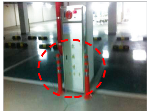
■ 소화전 충돌 방지 시설 설치
