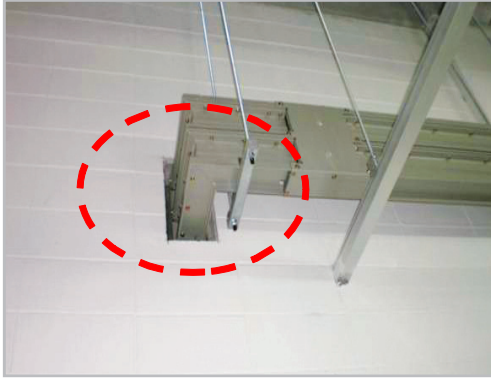
■ 전기실 트레이 인입 실간 방화실링 처리 미흡
