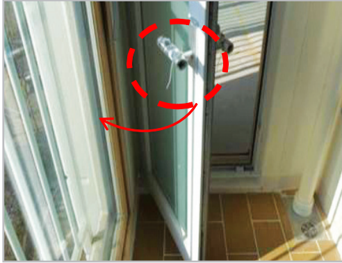
■ 발코니 출입문 손잡이 창호와 간섭
