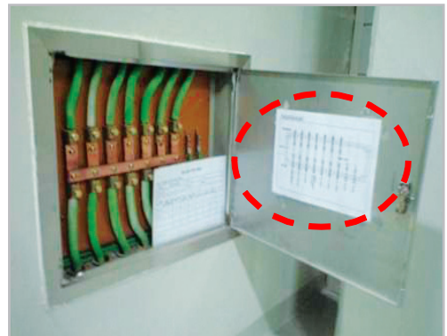
■ 접지선 종별 표기 및 접지저항측정표 부착
