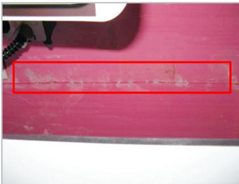
■ 최상층 세대 욕실 천장 단열재 결손
