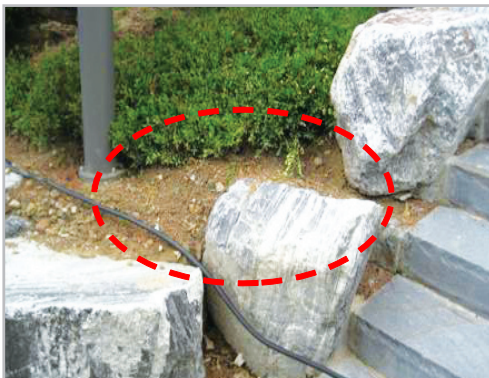
■ 자연석 설치 부위 표면 마감 미흡 (토양 유실 우려)
