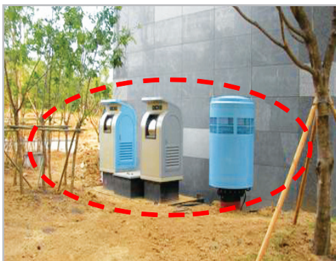
■ 쓰레기 이송 설비 지붕 미설치 (유지관리 및 사용 편의 고려 미흡)
