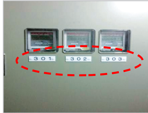
■ 전기계량기함 세대 호수 부착
