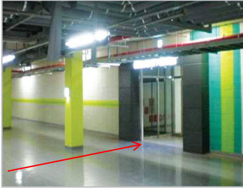
■ 지하주차장~동출입구 안전 표시 미흡
