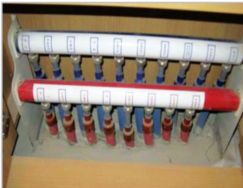
■ 신발장 하부 온수분배기 바닥 마감 처리 미흡
