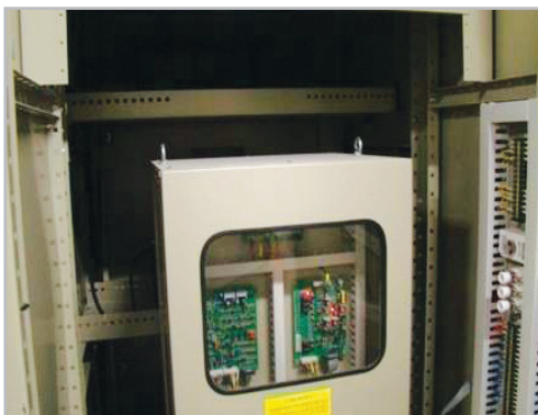
■ 전기실 배터리반~정류기반 사이차폐 처리 미흡
