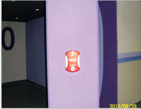
■ 지하주차장 비상벨 안내표기 미흡
