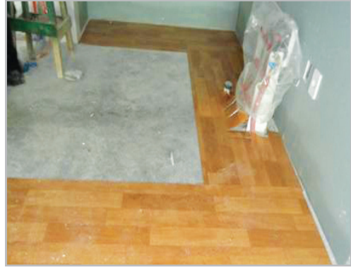
■ 주방 싱크장 하부 “비마감” 부위 장판 전시공
