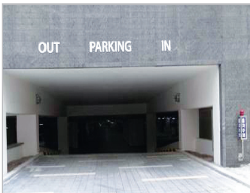
■ 지하주차장 진입 차량통행 제한 높이 표기 미흡
