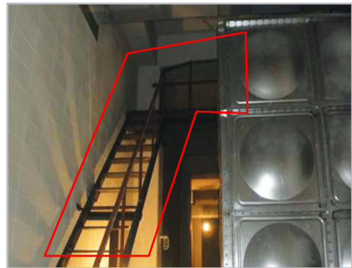
■ 지하저수조 점검용 계단설치로 유지 관리 편의
