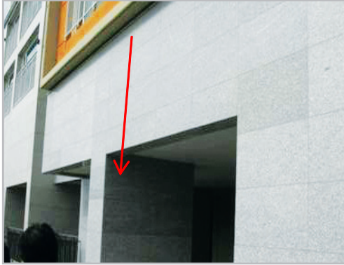
■ 필로티 낙하방지 안전시설 설치 미흡
