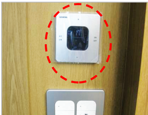
■ 욕실 바닥 난방 제어기 별도 설치
