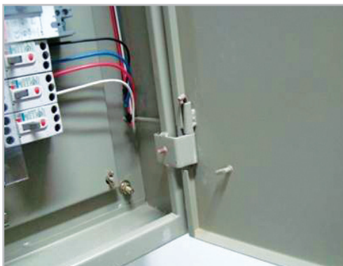
■ 전기 패널 내부 접지 시공 미흡
