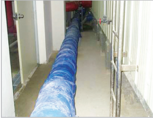
■ 지하저수조실 배관 발판 설치 미흡
