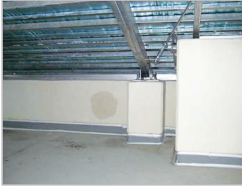
■ 옥상 경사지붕 내부 결로 발생 우려
