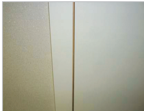
■ 가구장 수직/수평 마감 보완
