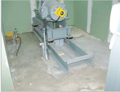
■ E/L기계실 바닥 노출 마감 - 먼지 발생 우려
