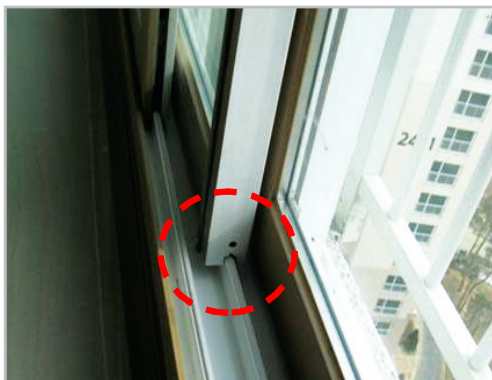
■ 각실 PL창호 기밀유지구(풍지판) 설치 누락 또는 오설치
