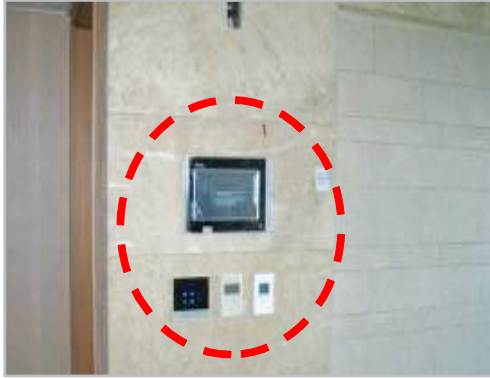
■ 거실 아트월 대리석 마감 미흡(이색)
