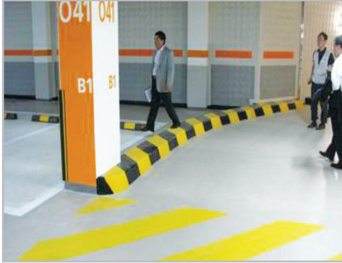
■ 지하주차장 램프~주차구획 간섭 부위 안전시설 미설치
