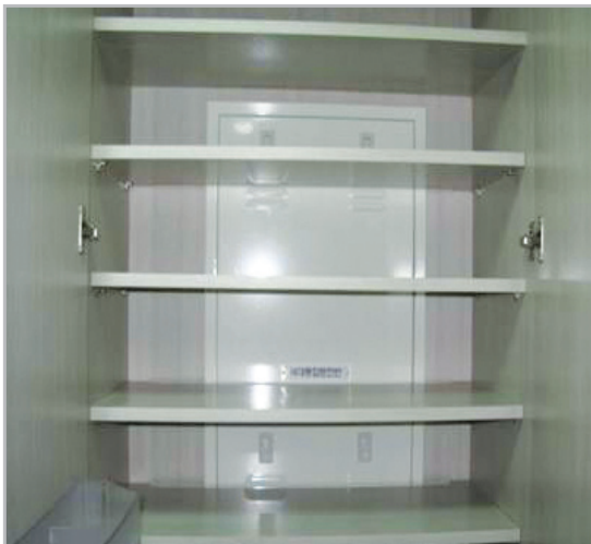
■ 현관 신발장 내부 세대분전반(통신단자함) 설치로 유지 관리 고려 미흡
