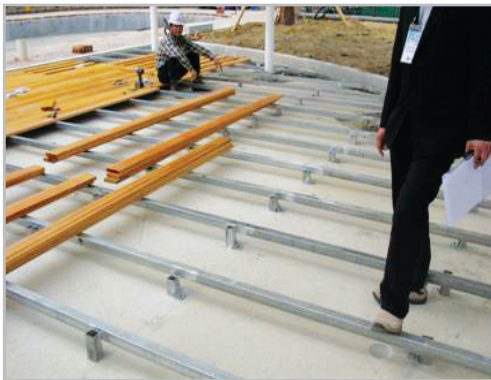
■ 단지내 목재 데크 드레인 점검구 미설치
