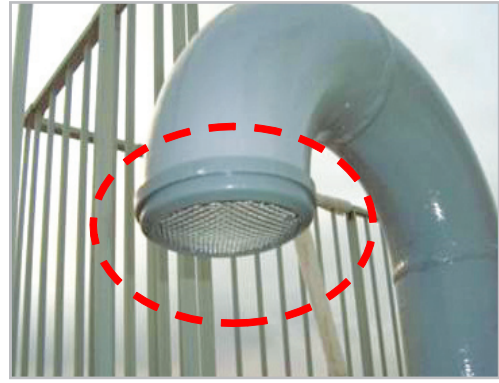
■ 옥상 통기구 방충망 설치 보완
