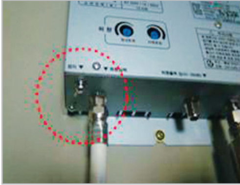
■ TV증폭기함 증폭기 접지 처리 미흡
