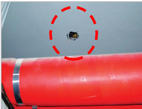
■ 지하주차장 상부 전기 풀박스 노출
