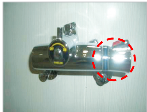
■ 보육시설 수전류는 온도 조절/고정형 으로 설치(화상 사고 방지)
