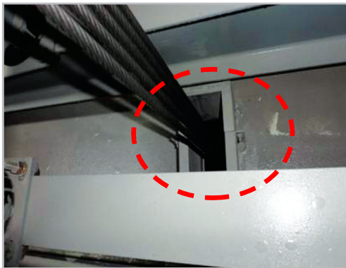
■ E/L기계실 승강기 인양 로프 인출구 소음 방지판 미설치
