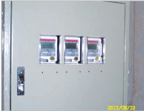
■ 세대 전기계량기함 세대 호수 미부착
