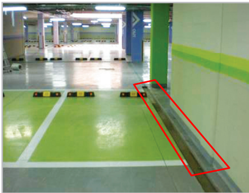
■ 주차구획 내 트렌치 커버 미설치
