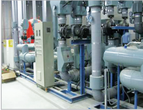
■ 기계실 각종 배관 용도 및 유체흐름 표기 미흡
