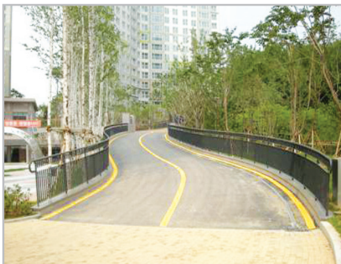
■ 단지내 도로 우수 처리 대책 미흡
