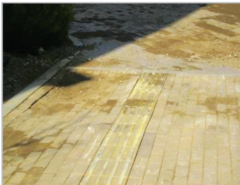
■ 단지내 보도블럭 평활도 미흡
