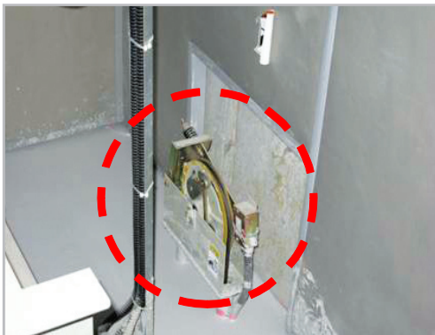
■ E/L기계실 벽면 마감재(흡음재) 미설치
