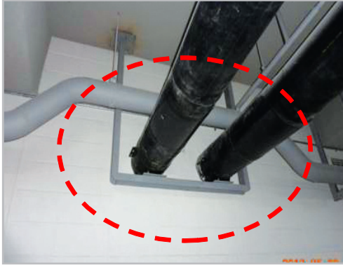
■ 지하주차장 중온수인입관 양카 고정 미흡
