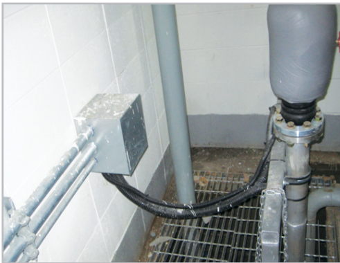
■ 영구배수펌프 인양용 가대 미설치
