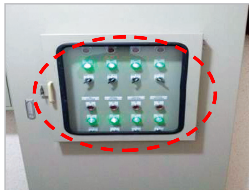
■ 전기패널 조작 스위치 안전커버 설치
