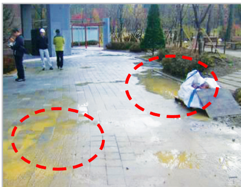
■ 단지내 보도블럭 물고임 발생
