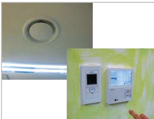
■ 각실 강제환기설비 설치(전열교환기 연결)
