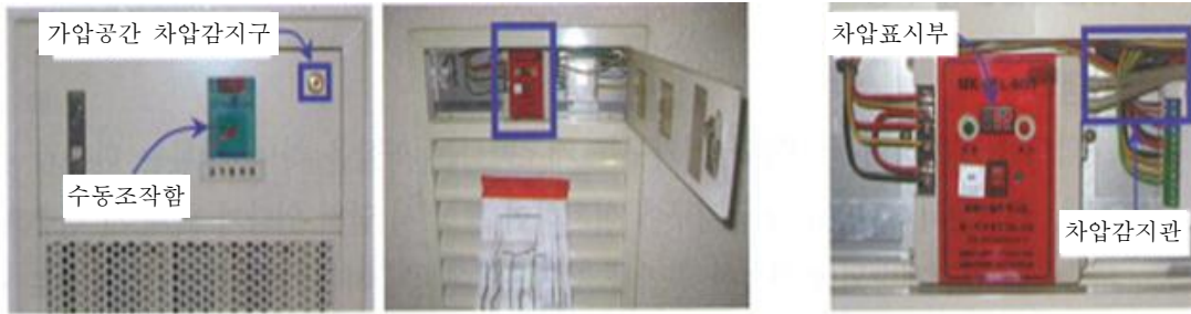
자동차압. 고압조절형 댐퍼 수동조작함
