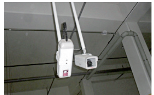
● 사각지대 CCTV 설치
