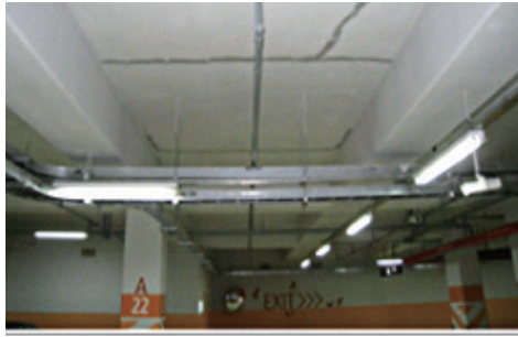
● 지하주차장 천장 슬래브 균열
