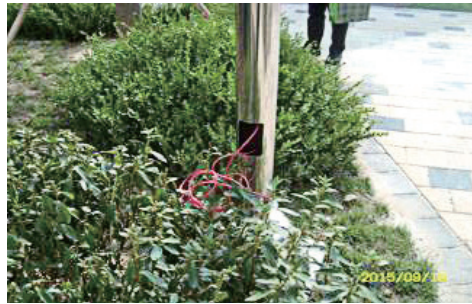
● 옥외 CCTV카메라 접지 누락
