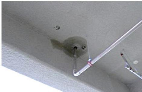
● 지하주차장 배관 관통부위 누수 발생
