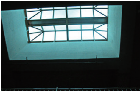
● 지하주차장 자연채광 도입 부분 안전 시설 미흡
