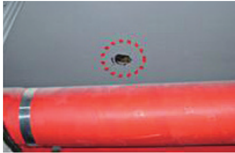
● 지하주차장 상부 전기 풀박스 노출
