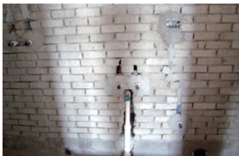
● 조적벽체 배관 매입부분 사춤 부족
