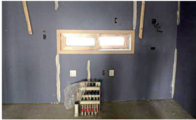
● 주방 외벽면 결로방지를 고려한 콘센트 단열 시공 양호
