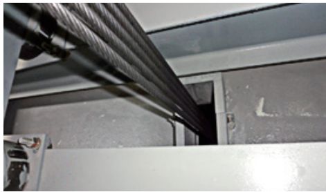
● 승강기계실 승강기 인양 로프 인출구 소음방지판 미설치
