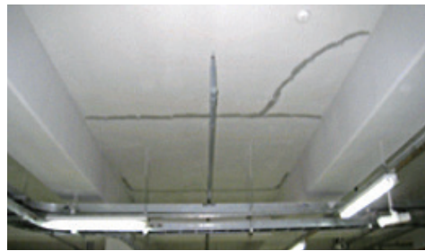
● 지하주차장 천장 슬래브 균열
