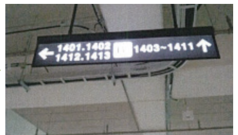
● 주차장 내부 차량유도 사인물 LED 표시 큰 글씨체로 하고, 주변 색채마감 및 시인성 고려 설치
