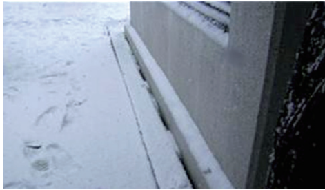
● 지하주차장 환기구 하부 마감처리 미흡
