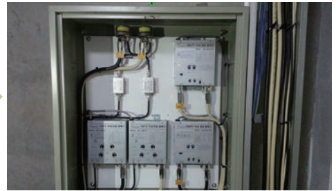
● TV중폭기함 내부 통신용 SPD(낙뢰보호기) 설치
