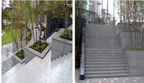
● 옥외 계단 난간 시공 및 플랜터에 대한 안전조치 필요
