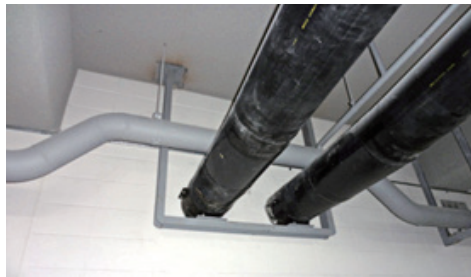
● 지하주차장 중온수인입관 앵커 고정 미흡
