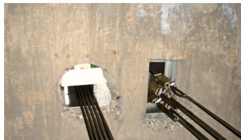
● 승강기 기계실 바닥 하부 마감불량
