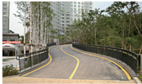
● 단지 내 도로 우수처리 대책 미흡
