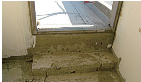
● 옥상 출입문 계단 높이 부적정 - 계단 높이 18cm 이하 유지
