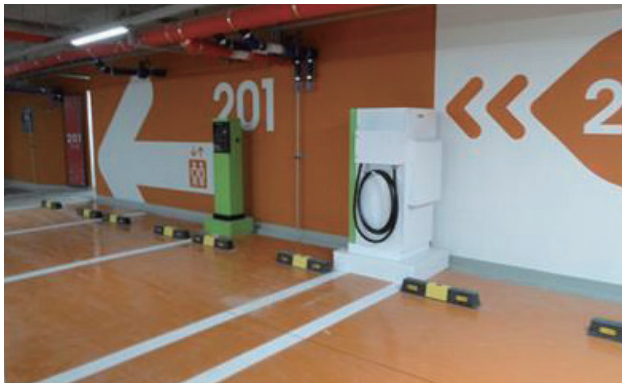
● 친환경시설인 전기차 충전시설 설치 우수
