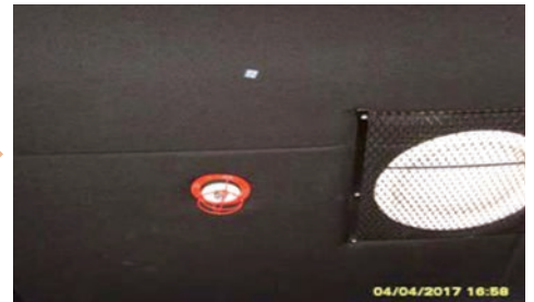
● 주민공동시설 스크린골프장 스프링 클러헤드 반자 돌출 적정
