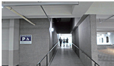
● 지하주차장 출입구 측면 보행통로 조도 추가 확보 필요
