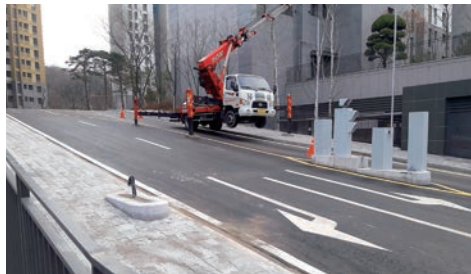
● 인도 및 차도 주차차단기 안전시설 누락
