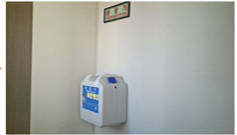
● 대피공간 완강기 고정식으로 설치 (3층 - 10층)
