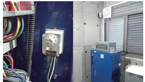
● 환기용 팬에 온도감지형 센서 설치로 일정 온도 상승시 자동작동 (유지관리 용이)
