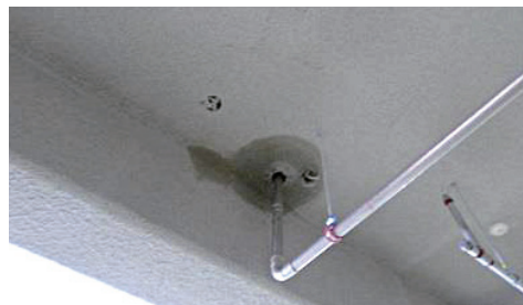
● 지하주차장 배관 관통부위 누수 발생
