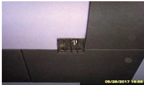
● 주민공동시설 스크린골프장 스프링 클러헤드 가드로 인한 반자 돌출 불량
