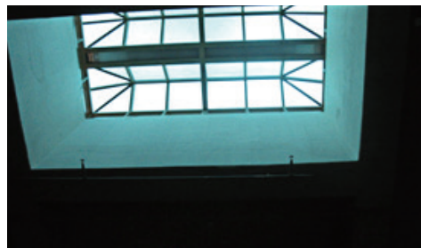
● 지하주차장 자연채광 도입 부분 안전 시설 미흡
