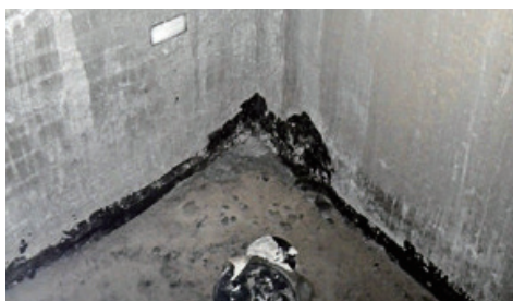
● 욕실 코너부위 · 배수구 주변 방수 처리 미흡
