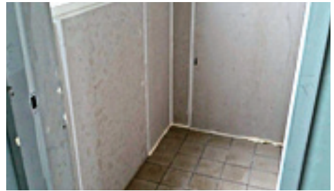
● 발코니 결로방지를 위한 단열재 및 CRC 보드 등 추가 시공 권장
