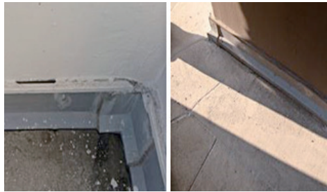
● 옥상 방수 치켜올림 PVC 보호캡 마감 처리 미흡
