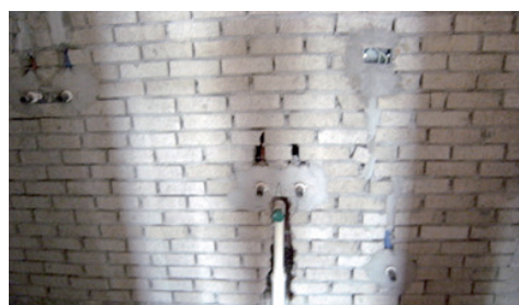
● 조적벽체 배관 매입부분 사춤 부족
