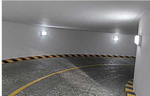
〈반사경 설치 미흡 예시〉
