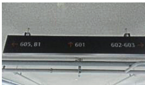
● 주차장 내부 차량유도 사인물 LED 표시 시인성 향상 대책 필요
