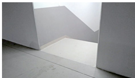
● 지하주차장 침수 시 전기실 물 유입 우려
