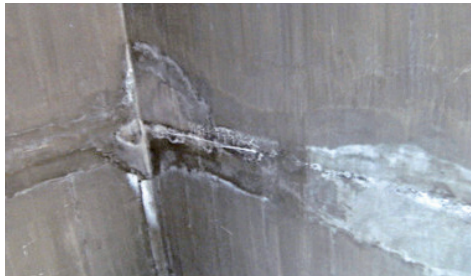
● 조인트 누수로 인한 백화 제거 필요
