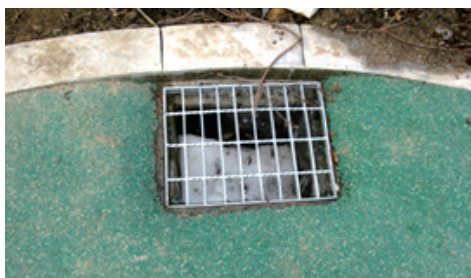
● 어린이놀이터 내부 설치된 배수 트렌치 안전사고 우려
