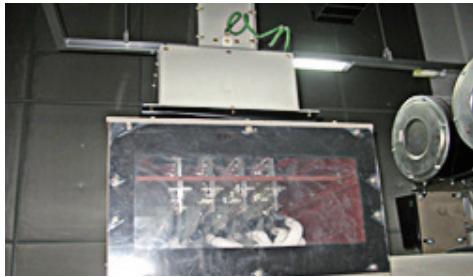
● 발전기실 부스덕트 상부에 점검용 아크릴판 미부착
