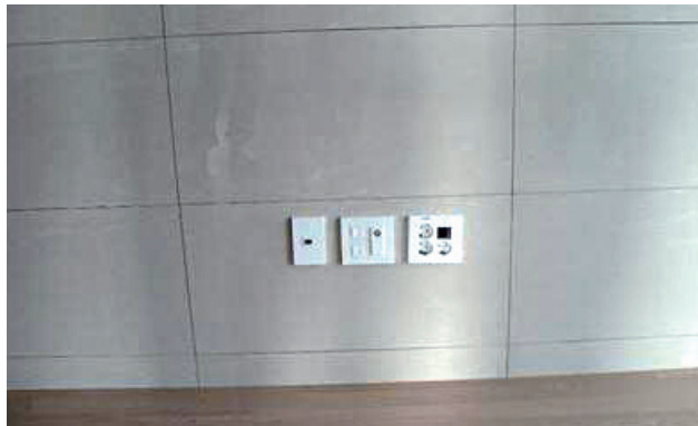
● 세대 AP설치 및 대기전력차단 콘센트 설치 양호
