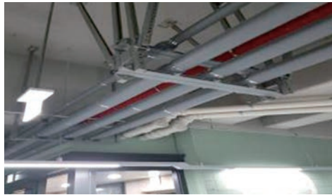
● 설비 배관 명칭 및 유수흐름 방향 미표기
