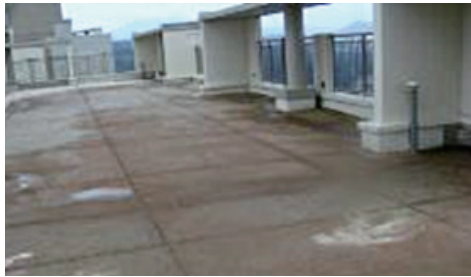
● 옥상 바닥 물고임 및 배수 불량
