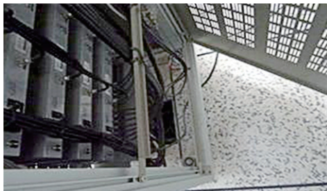
● CCTV단자반 및 TV단자반 등 각종 단자반에 외함 접지 미흡
