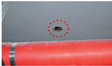
● 지하주차장 상부 전기 풀박스 노출
