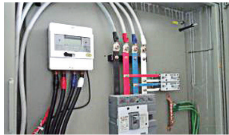
● 승강기기계실 분전반 전력량계 미설치
