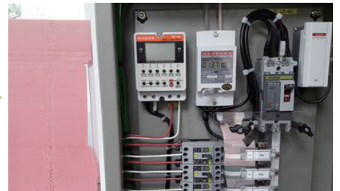
● 주출입구 문주등 타이머를 '일출일몰 자동 정전보상형'으로 설치
