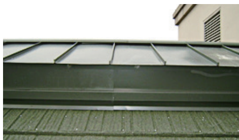
● 옥상 경사지붕 내부 환기구 미설치
