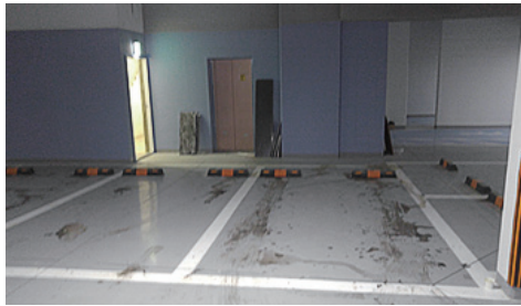
● 계단 및 엘리베이터 앞에 주차면 설치로 보행자 통행 어려움
