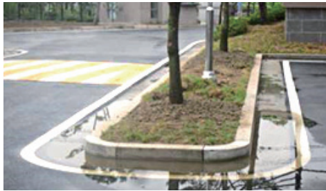
● 측구 및 포장구배 불량으로 물고임 발생
