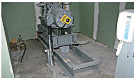
● 승강기 기계실 바닥 노출로 먼지 발생 우려
