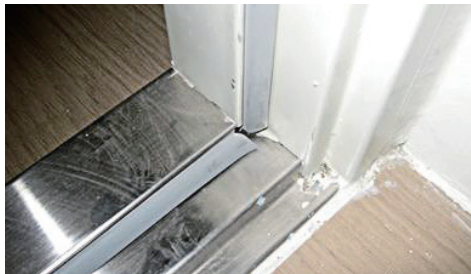
● 방화문 개스킷 설치 부적정
