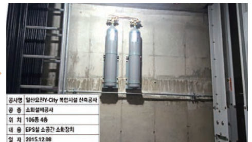
● 소공간 자동소화장치 설치
