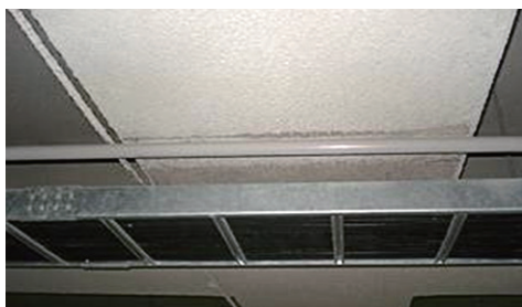
● 지하주차장 트레이 상부 뽐칠 누락
