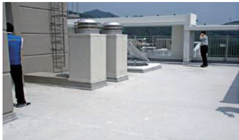
● 옥상 누름콘크리트 커팅 부분 코킹처리 미흡
