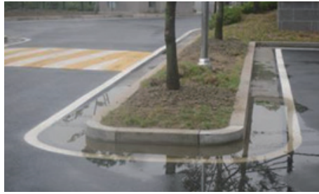
● 측구 및 포장구배 불량으로 물고임 발생
