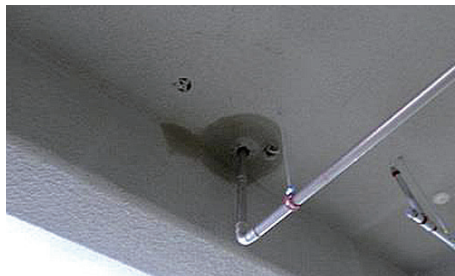
● 지하주차장 배관 관통부위 누수 발생
