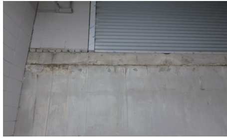
● 발전기실 장비반입구 마감 처리 미흡
