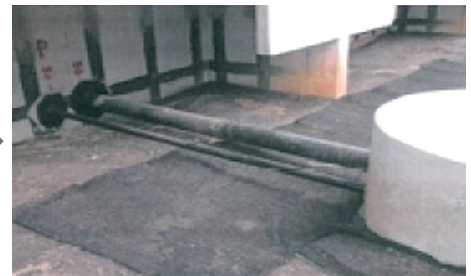
● 설비배관과 토목배관 동일자재 연결로 시공성 향상 및 누수하자 예방
