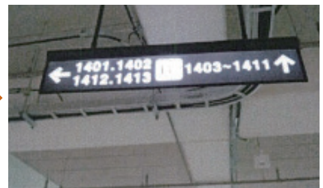
● 주차장 내부 차량유도 사인물 LED 표시 글씨 크기 크게, 주변 색채마감 및 시인성 고려 설치
