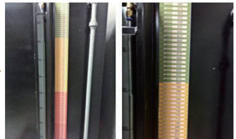
● 비상발전기 경유탱크 한계수위 표시 (4면 방유턱 시공)
