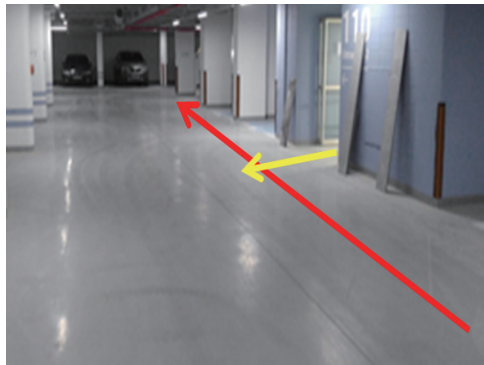
〈잘못 설치된 예시〉
