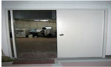
● 지하주차장 피트부분 폐쇄 시공 필요
