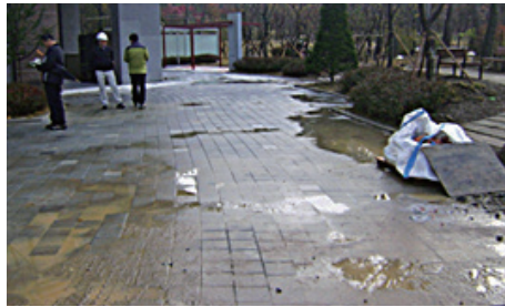
● 단지 내 보도블록 물고임 발생
