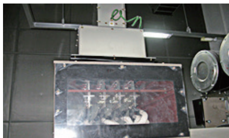
● 발전기실 부스덕트 상부에 점검용 아크릴판 미부착
