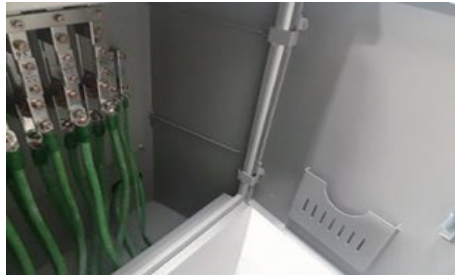
● 접지단자함 접지저항 측정기록표 미부착
