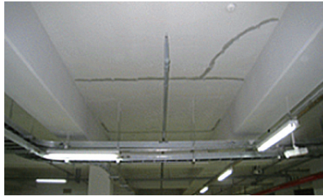
● 지하주차장 천장 슬래브 균열
