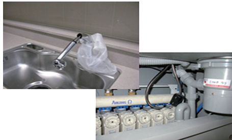
● 주방 싱크대 탈착식 수전 하부 무계추 간섭으로 작동 불량
