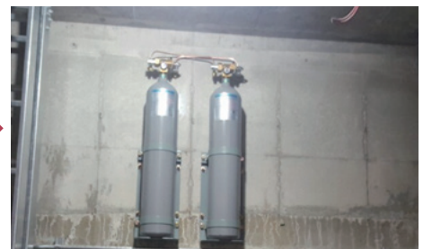
● 소공간 자동소화장치 설치
