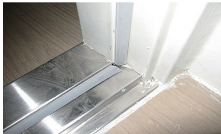
● 방화문 개스킷 설치 부적정
