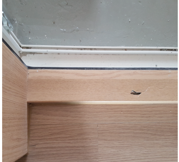
실외기실 방화문 문턱 파손
