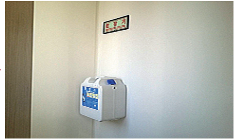
● 대피공간 완강기 고정식으로 설치 (3층 - 10층)
