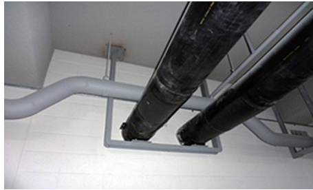
● 지하주차장 중온수인입관 앵커 고정 미흡
