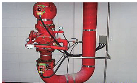
● 지하주차장 스프링클러 프리액션 밸브 방호 구역 표지 미설치
