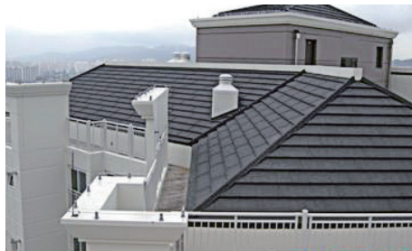
● 옥상 경사지붕 내부 점검구 및 점검용 전등 설치 필요
