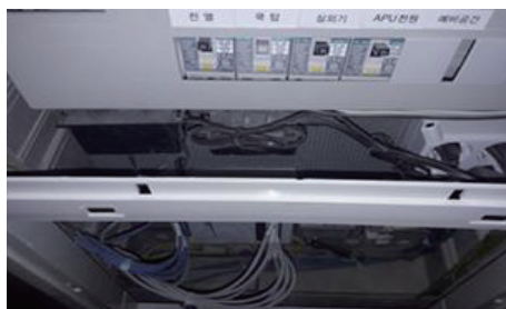
● 전기분전반과 통신단자함 미분리 및 동일 공간에 설치
