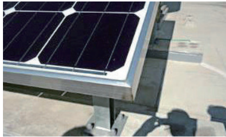
● 태양광 발전시스템 날카로운 모서리 마감 처리 필요
