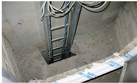
● 벽체 및 바닥 관통부위 내화충전재 미설치
