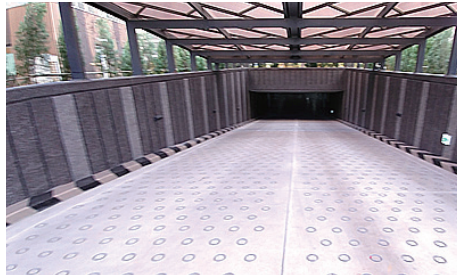
● 지하주차장 램프 연석 도색 설치 미흡
