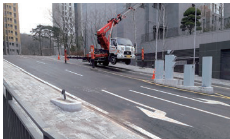
● 인도 및 차도 주차차단기 안전시설 누락
