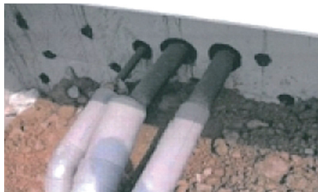
● 설비배관과 토목배관 시공범위로 인한 연결 배관 재질이 상이하어 누수 하자 발생
