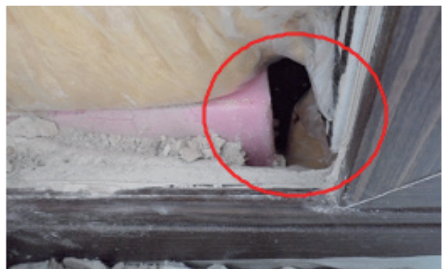
단열재 해체부위(단열재 일부누락)
