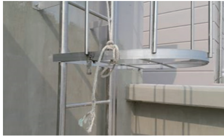
● 옥탑 점검사다리 시건장치 미설치
