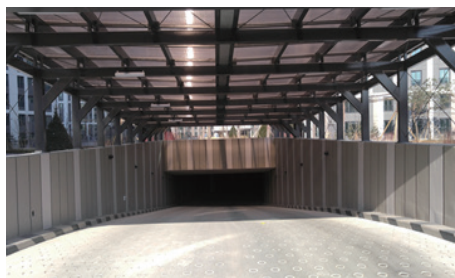
● 지하주차장 램프 진출입 차량 진행방향 및 주행경로 안내를 위해 중앙선 설치 필요
