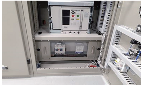
● 전기실 수배전반 VCB 내부에 수동조작봉 미비치
