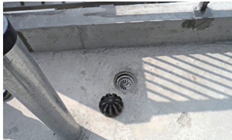
● 옥상 우수드레인 커버 분실 방지 대책 검토
