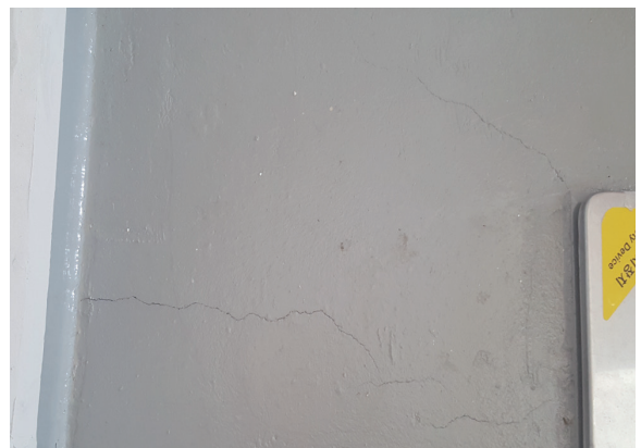
대피실 바닥 균열 ▶
