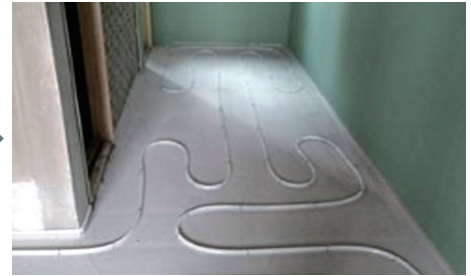
● 난방코일설치(동절기 결로방지 및 하절기 제습 효과)
