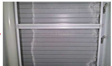
● 실외기실 갤러리 창호 방충망 설치(갤러리 개폐각도 90° 여부 확인) ※ 에어컨실외기 전용 갤러리창은 에어컨 가동시 자동으로 개폐되는 자재 검토 바람
