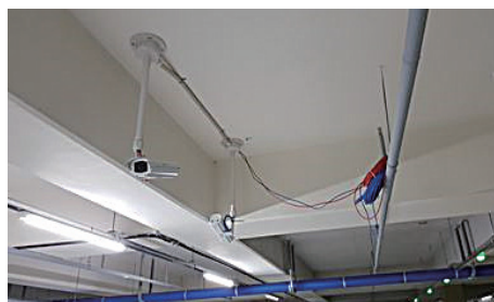
● 지하주차장 CCTV 설치 및 Cable의 여장 정리 등의 공사 마무리 미흡
