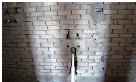
● 조적벽체 내 배관 매입부분 사춤 부족
