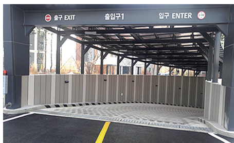
● 지하주차장 램프 곡선구간 노면표시 미설치 및 시거 불량
