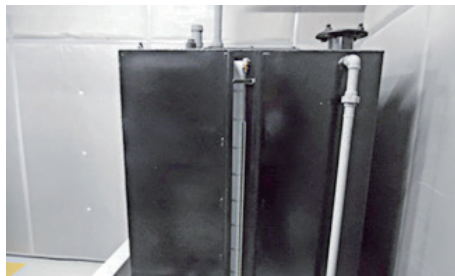
● 비상발전기 경유탱크에 용량 안내 및 한계수위 표시 필요 (2면만 방유턱 시공)
