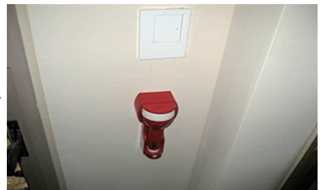
● 대피공간 비상조명등 설치
