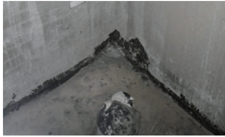
욕실 코너부위 · 배수구 주변 방수 처리 미흡
