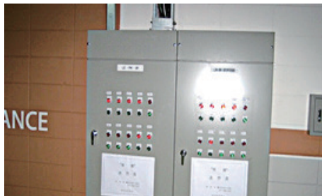
● 전기패널 노출로 차량 진입 시 파손 우려
