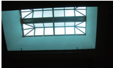
● 지하주차장 자연채광 도입 부분 안전시설 미흡
