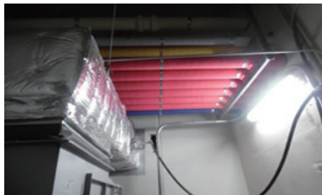
● 제연팬룸 하부 SP헤드 추가 설치 필요
