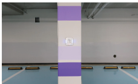
● 지하주차장 비상벨 안내표기 미흡 및 시인성 낮음
