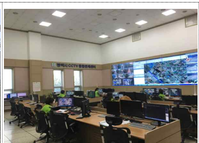
《시군 CCTV 통합관제센터》
