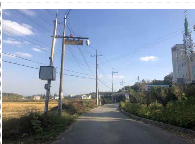
《방범 CCTV 설치》
