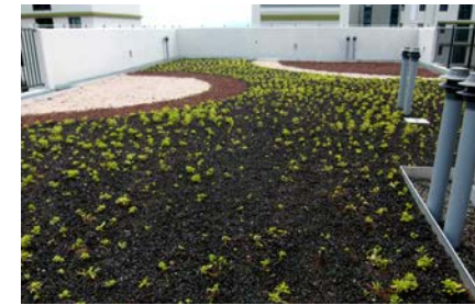
▲ 옥상 화단 조성 시 수전 미설치로 물 공급 어려움
