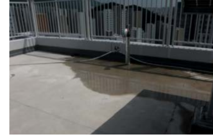
▲ 옥상 바닥 물고임 및 배수 불량
