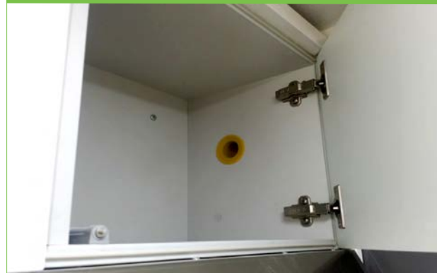
▲ 주방 피트 내 누수 여부 점검을 위한 내시경카메라 점검구 별도 설치
