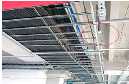
▲ 주변 시설물로 인해 지하주차장 S/P 헤드 살수 장애 우려
