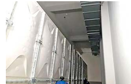
▲ 저수조실 내 조명 미설치
