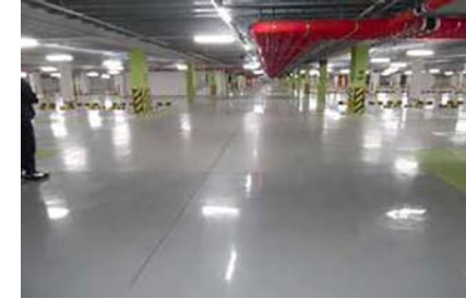
▲ 지하주차장 내 장거리 주행구간에는 과속방지시설 설치 필요
