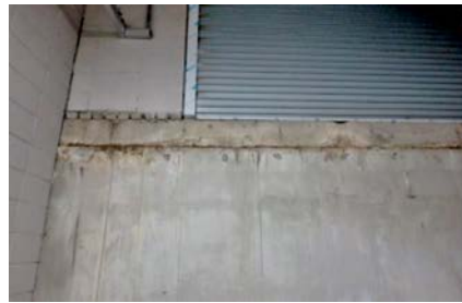
▲ 발전기실 장비 반입구 마감처리 미흡
