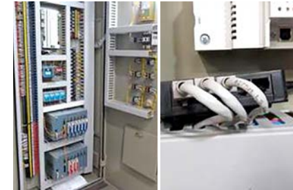
▲ 기계실 MCC반 입출력 리스트 미비치 및 수위계·허브 연결단지 용도 미표기
