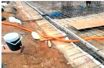
▲ 철근 위 근로자 안전 통로 미확보
