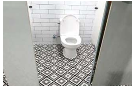
▲ 장애인 화장실 장애인용 손잡이 등 미시공
