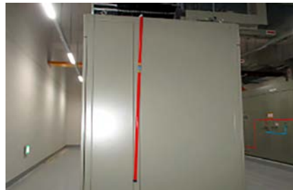
▲ 변압기반 DS봉의 별도 보관장소가 없어 분실우려로 비상 시 조속한 사용 어려움
