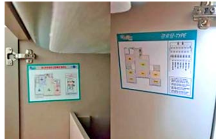
▲ 싱크대 하부 문 내부에 난방구획도 부착
