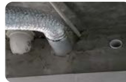
●슬리브 주위 사춤 및 미장 불량
