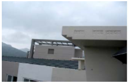
▲ 옥상 장식물 경사도 처리 미흡 (외부 고드를 낙하 우려)
