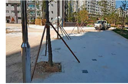
▲ 가로수 보호용 삼각 지주대가 보도에 설치되어 어린이 및 보행자의 안전사고 우려
