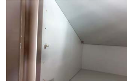
▲ 일반형 핀 고정재 사용 시 선반 탈락 우려
