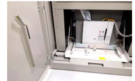
▲ 전기실 수배전반 VCB 수동 조작봉 내부 수납 비치
