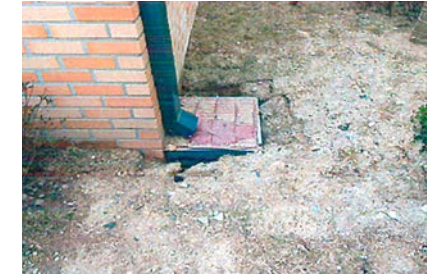
▲ 부대 복리시설 집수정 주변 침하
