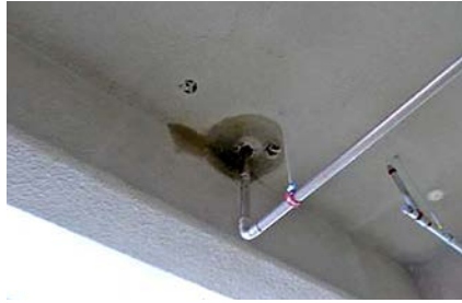
▲ 지하주차장 배관 관통부위 누수 발생
