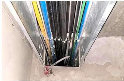
▲ TPS실의 트레이 시공 후 개구부에 층간 방화처리제 미시공으로 화재 안전 미흡
