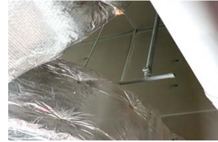
▲ S/P 교차 배관 및 가지 배관 말단부에 내진 버팀대 설치 필요
