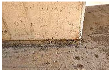
▲ 기둥 하부 재료분리로 인한 단면 손실부는 기둥과 동일한 강도의 무수축모르타르로 보강 필요
