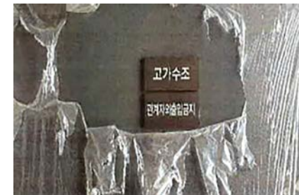
▲ 소화수조실이 고가수조실로 표기됨
