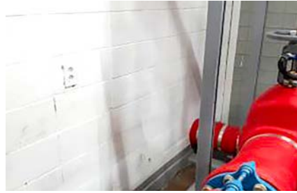
▲ 기계실 장비와 인접한 위치에 일반형 콘센트 설치
