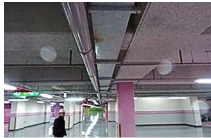
▲ 지하주차장 상부 특고압 인입덕트 위험표지판 미부착
