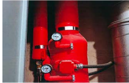
▲ 공용복도에 위치한 알람벨브에 사용설명서 미비치
