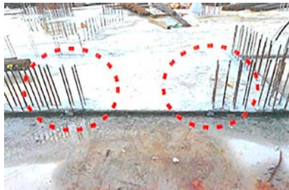
▲ 통로 철근 노출 부위 시인성 확보 및 찢림 사고 예방 필요
