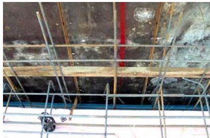
▲ 슬래브 상부근이 외벽 피복두께 위치까지 도달 못함
