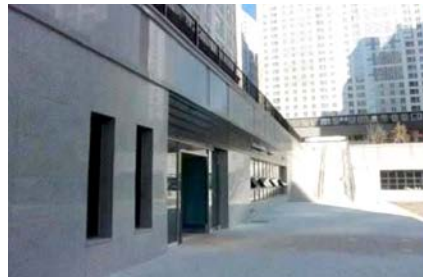
▲ 부대복리시설 출입구 상부에 캐노피가 없어 이용자 불편 초래
