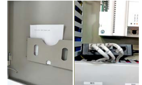
▲ 기계실 MCC반 입출력 리스트 비치 및 수위계·허브 연결단지 용도 표기
