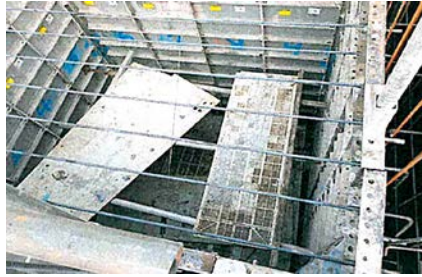
▲ 승강기 피트 작업 시 철근 상부 합판 설치상태 불량하여 추락 및 낙하 위험
