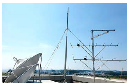
▲ 옥상 TV안테나와 피뢰설비 간 이격거리 부족과 피뢰설비 높이 미비
