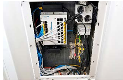
▲ 각 배선과 맞도록 세대배치도 비치 및 각 케이블 여장정리 미흡
