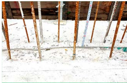
▲ 지하 외벽 시공 이음부에 지수판 설치 불량으로 누수 우려
