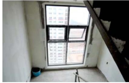
▲ 계단참 하부 유리부분 안전난간 설치 필요
