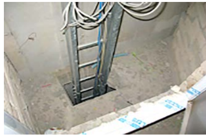
▲ 방화구획에 해당되는 벽체 및 바닥 관통부위 발생, 방화구획 미인정
