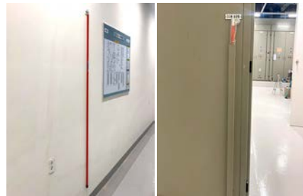
▲ 시인성이 좋은 위치에 DS봉 벽면 거치 또는 별도 보관
