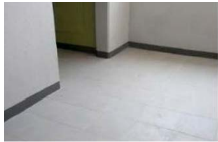
▲ 승강기홀 및 계단실 바닥 등 타일줄눈 처리 미흡(특히 벽과 접하는 부분)
