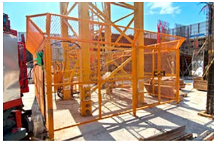
▲ 타워크레인 방호울타리에 관리자, 운전원, 제원표 등 부착 필요
