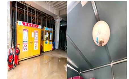
▲ 확산 소화기 및 20kg 대형 소화기 설치
