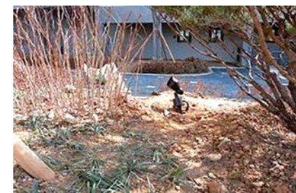
▲ 수목 투사등 기초는 콘크리트로 개선 보완 필요
