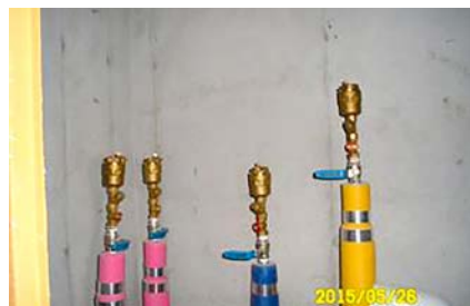
▲ 최상층 배관 말단기구에 열손실 및 동결방지 보온 미조치
