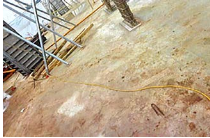
▲ 전선 바닥 존치로 감전 및 누전 위험
