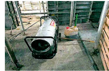
▲ 열풍기와 유류 인접 배치로 화재 발생 위험
