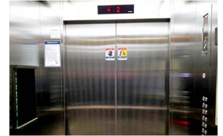
▲ 승강기 내부 출입문에 주의사항 표지 부착 및 안내방송 송출
