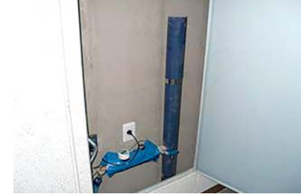
▲ 최상층 공용 PD내부에 설치된 급수 입상배관이 흔들리지 않도록 견고하게 고정 필요
