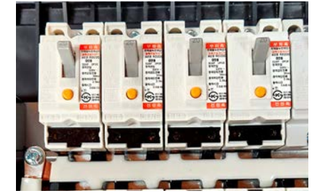
▲ 분기차단기를 정방향(위쪽 커짐)으로 설치하여 오조작 사고 예방
