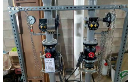
▲ 수중펌프 성능 확인을 위한 압력계 설치 위치 차선책으로 설치
