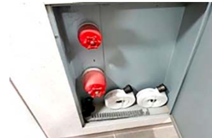
▲ 옥내소화전함 내 호스 및 관창 방수구 미연결
