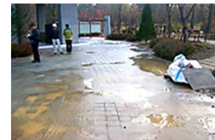
▲ 단지 내 보도블록 물고임 발생
