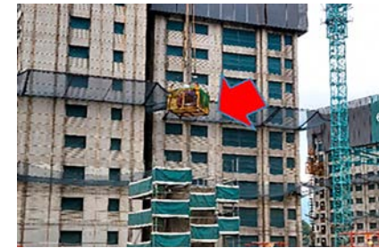
▲ 타워크레인 자재 인양함 유도로프 미사용
