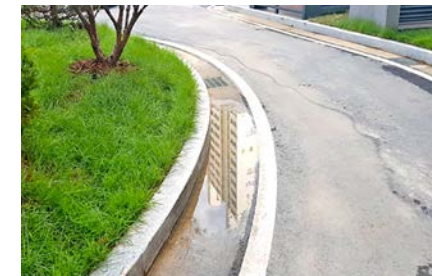
▲ 측구 구배 불량으로 물고임 발생
