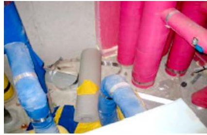
▲ 승강기홀 PD, EPS, TPS실 내부 청소상태 미흡
