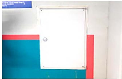
▲ 지하 피트 점검구 표면에 유지관리를 위하여 내부에 수납된 장비나 자동밸브류 등의 명칭 부착 바람
