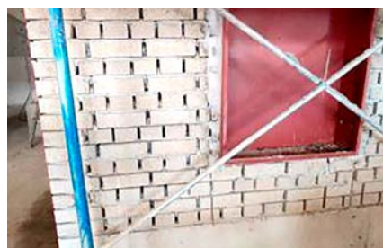
▲ 조적 벽체 내 배관 매입 부분 사춤 부족
