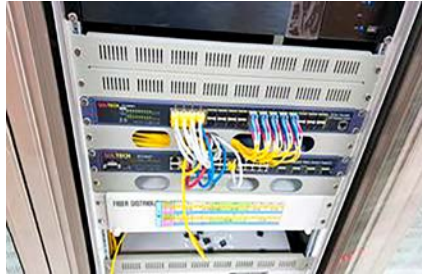
▲ 광커넥터 별 해당 라벨링 미비 및 각 FDF 선번장 관리 미비
