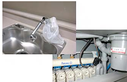
▲ 주방 싱크대 탈착식 수전 하부 무게추 간섭으로 작동 불량
