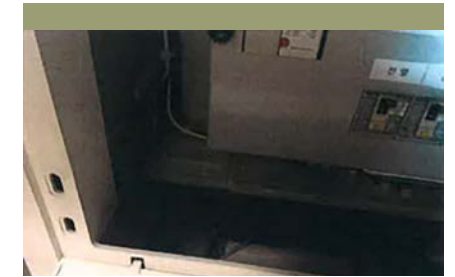
▲ 전기분전반과 통신단자함 동일 공간에 설치 시 사이에 격벽 설치 등 분리 조치
