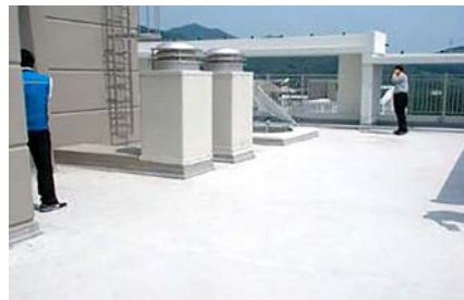
▲ 옥상 무근 콘크리트 커팅 부분 코킹 처리 미흡
