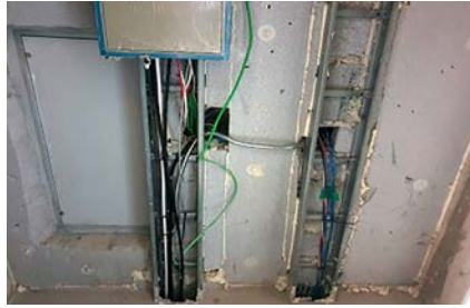
▲ TPS실의 통신케이블의 시공 및 청소상태 미흡
