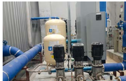
▲ 장비 배수 배관 미설치
