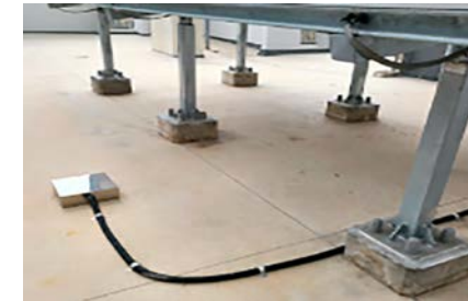
▲ 태양광 배관 보호 마감 및 강제 전선관으로 시공 필요
