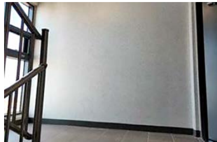
▲ 옥상 대피를 위한 안내시설 및 승강기 기계실 진입제한 시설 설치 필요
