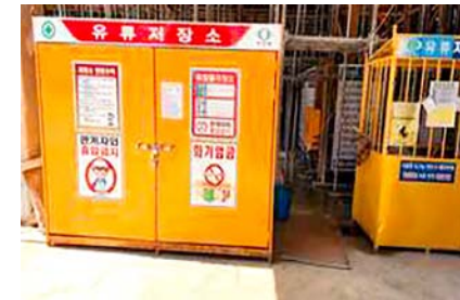
▲ 위험물저장소 내부 확산 소화기, 외부 분말소화기 설치 필요
