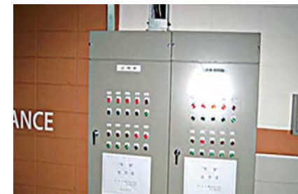
▲ 전기패널 노출로 차량 이동 시 파손 우려
