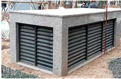
▲ 환풍기 시설 하부와 녹지대 높이 동레벨 시공으로 시설 내 우수 유입 방지를 위한 우배수 조치 필요
