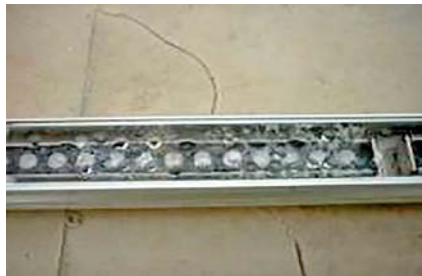
▲ 옥상층 외부 조명 내부 결로현상 발생
