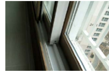
▲ PL창호 풍지판(기밀유지) 설치 누락
