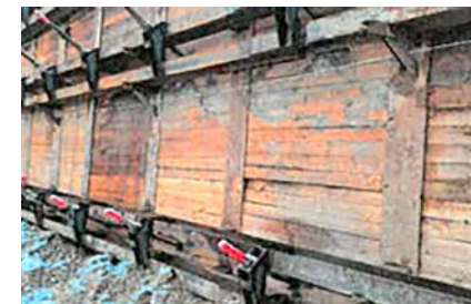
▲ 토류판 변형 발생 부위 보수 필요
