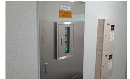
▲ 스위치 외부에 보호 조치
