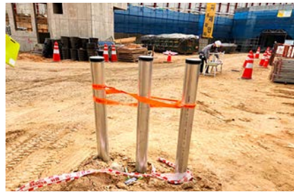
▲ 옥외 연결송수구 설치위치와 조경, 도로 간섭 여부 등 검토 미흡
