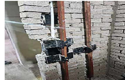
▲ 욕실 조적 벽체 품질 상태 불량
