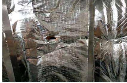
▲ 지하주차장 제연웬룸 내부 제연덕트 TAB 측정용 홀이 마감되지 않아 누기 우려 있음
