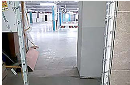
▲ 각 동 공동현관, 지하출입구 자동문 상부 센서 고장 및 수동전환 대책 필요
