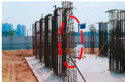
▲ 필로티 웅벽철근 조립구간의 철근 전도방지를 위한 버팀대 설치 미흡
