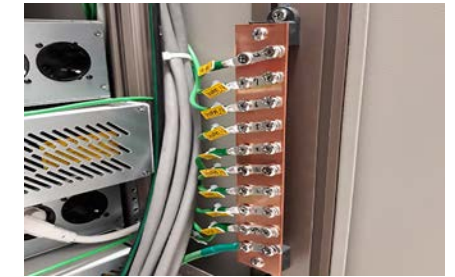
▲ 랙의 접지선과 각 장비 간 접지선을 연결하여 장비 안전성 확보
