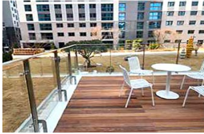
▲ 커뮤니티 2층 유리난간 안전사고 우려
