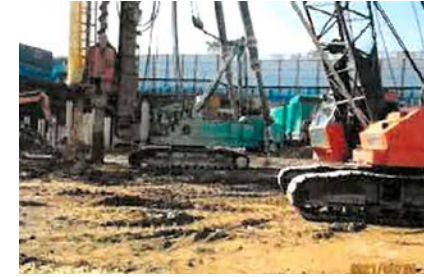
▲ 보조 크레인 주변 연약지반 전도방지를 위해 복공판 설치 필요
