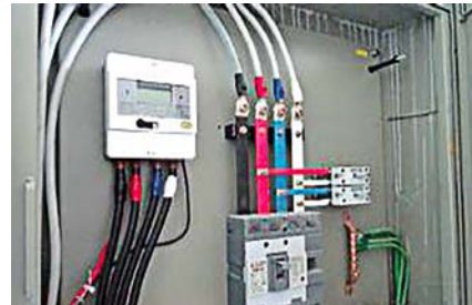
▲ 승강기 기계실 분전반 전력량계 미설치
