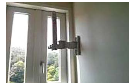
▲ 세대 대피공간 완강기 거치대 사용설명서 벽체에 확대 부착 및 입주민에게 사용방법 안내 바람
