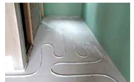
▲ 난방코일설치(동절기 결로방지 및 하절기 제습 효과)
