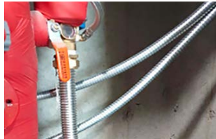
▲ 알람벨브 배수관 상부에 신정통기관 설치 필요
