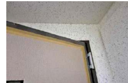
▲ 세대 방화문 상부 사인장 균열 발생
