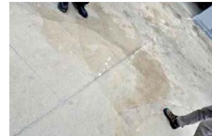
▲ 옥상 유도 줄눈 코킹 시공 불량
