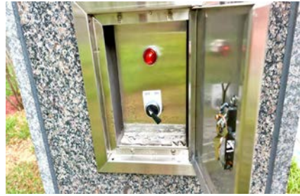
▲ 옥외 연결송수구 펌프용 수동스위치함 우수 유입방지 미흡
