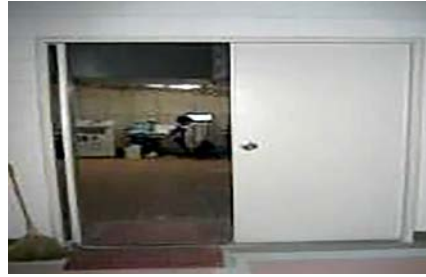
▲ 지하주차장 피트 폐쇄 시공 필요
