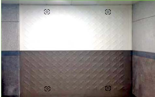
지하주차장 배수판 환기구
