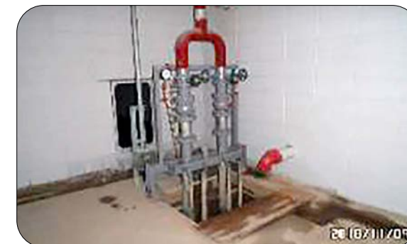
< 기계실로 오버플로우배관 유도, 침수우려 有 >
