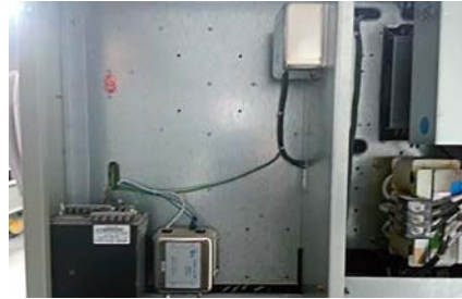
▲ 서지보호장치(SPD) 설치(제어반 뒷면) 및 분진청소
