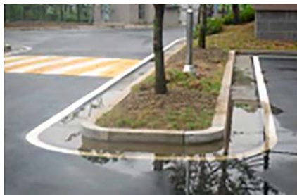
▲ 측구 및 포장구배 불량으로 물고임 발생
