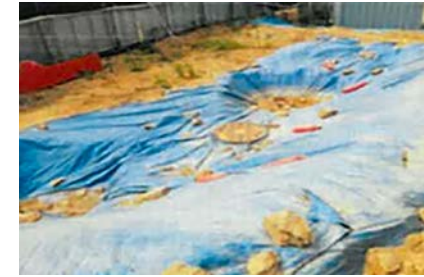
▲ 단지 주변 침사지 설치 및 관리 필요
