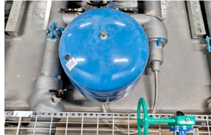
▲ 급수 압력탱크 퇴수배관 및 밸브 누락
