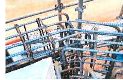
▲ 기둥에서 둔각으로 만나는 두 보의 상부 철근 갈고리 정착 시공 오류
