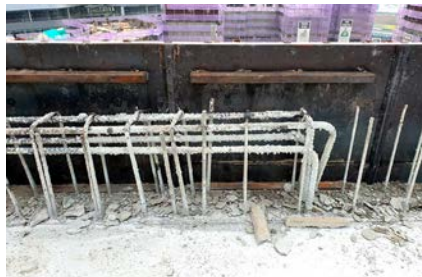
▲ 콘크리트 찌꺼기 부착으로 인하여 철근의 부착성능 저하 및 품질저하
