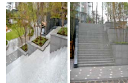
▲ 옥외 계단 난간 시공 및 플랜터에 대한 안전조치 필요
