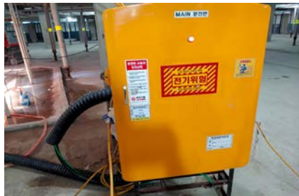
▲ 분전반 시건장치 설치 및 관리책임자 지정 표기 필요
