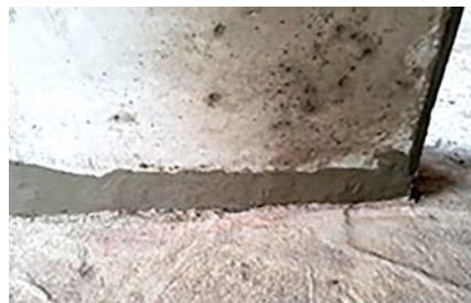
▲ 벽체 하부 재료분리 부위 폴리머모르타르 (보수 승인 제품)를 사용하여 보수 완료
