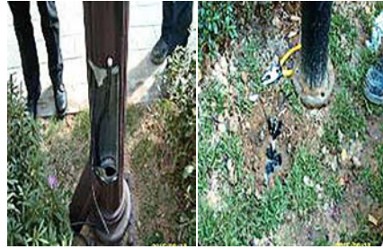
▲ 옥외 보안등 및 산책로 조명등의 전기시설물 개별 및 연결접지 필요
