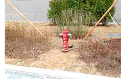
▲ 옥외 상수도 소화전 안전 보호대 및 소화용수 표지 미설치
