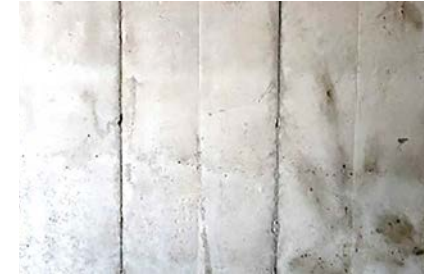
▲ 세대 벽체 콘크리트 균열 발생
