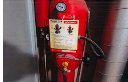
▲ 공용복도에 위치한 알람벨브에 사용설명서 비치
