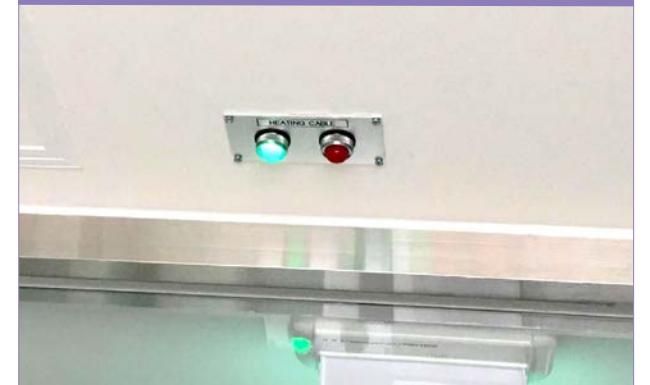
동파방지 열선 작동 램프
