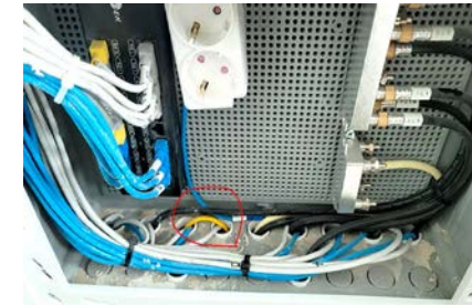
▲ TPS L2 스위치와 세대단자함 통과 케이블의 여장이 확보되지 않게 시공
