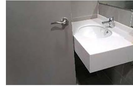
▲ 화장실 출입문과 세면기 간섭 발생
