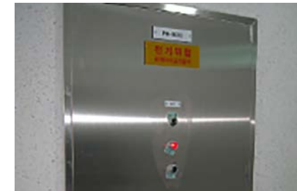
▲ 옥상 출입구 인근 전기판넬 작동 스위치에 시간장치 필요
