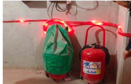
▲ 소화기는 평소 압력계 확인하여 사용가능상태로 유지관리
