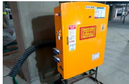
▲ 분전반 시건장치 설치 및 관리책임자 지정 표기
