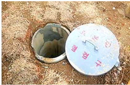
▲ 녹지대 수직 우수드레인 및 각종 점검구 잠금장치 미설치로 어린이 등 안전사고 우려
