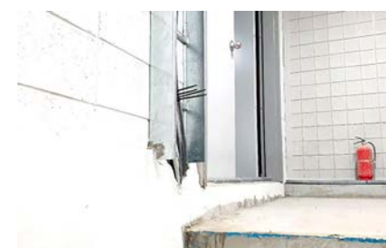
▲ 안전사고 예방을 위해 기계실 내 트레이 보호 커버 설치 필요
