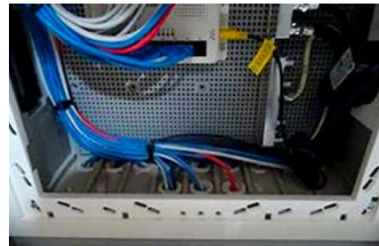
▲ 전기분전반 및 전화단자반 외부 인입배관 결로방지 대책 검토
