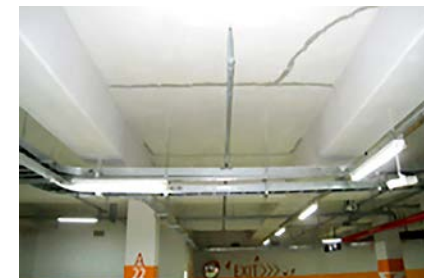
▲ 지하주차장 천장 슬래브 균열
