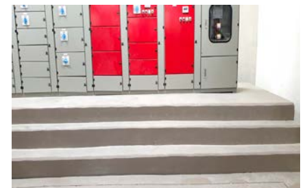
▲ MCC 판넬 PAD 0.9m 이상 설치
