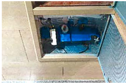
▲ 수도계량기 동파방지 열선의 전기 콘센트는 누수 시 감전 위험 있음
