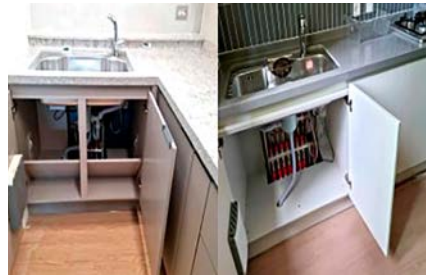
▲ 싱크대 하부 온수분배기의 난방구획도 누락
