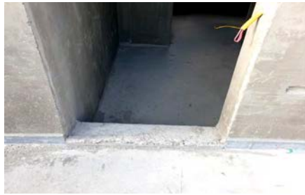
▲ 옥상 바닥과 출입구 턱 단차가 없어 폭우 시 우수 실내로 유입 우려
