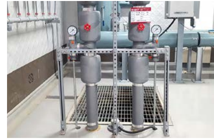
▲ 맨홀은 스틸 그레이팅 재질로 하고 내부 청소가 용이하도록 개폐 가능한 구조로 설치
