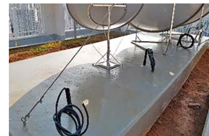
▲ 안테나용 동축케이블 마감처리 불량으로 우수 유입 문제
