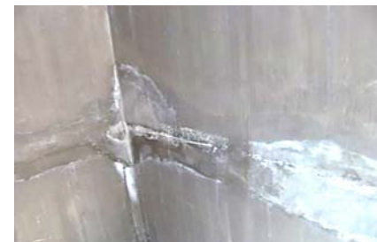
▲ 조인트 누수로 인한 백화 제거 필요
