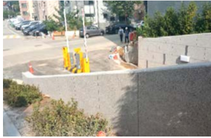
▲ 주차장 램프 상단 골조 난간 높이(1.2m) 기준 미달로 안전사고 우려
