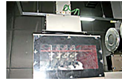
▲ 발전기실 버스덕트 상부에 점검용 아크릴판 미부착
