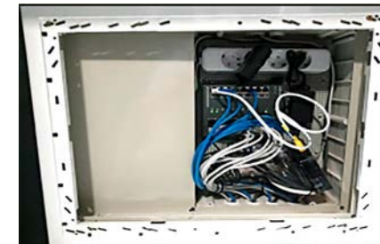
▲ 세대 통신단자함의 내부 사이즈가 규정보다 작게 시공하여 설치 공간의 부족
