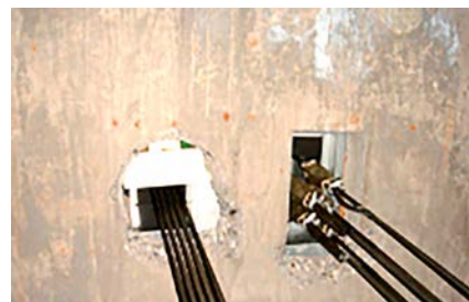
▲ 승강기 기계실 바닥 하부 마감 불량
