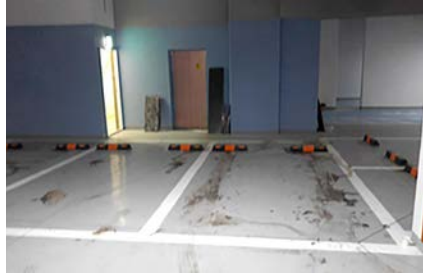
▲ 계단 및 엘리베이터 앞에 주차면 설치로 보행자通行 어려움
