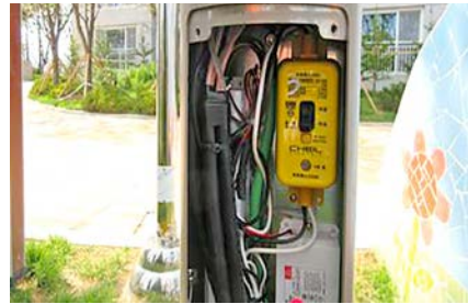
▲ 방수형 누전차단기 설치하여 내부결로 및 누수에 따른 누전 방지
