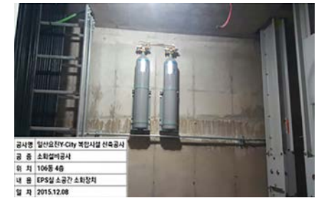
▲ 소공간 자동소화장치 설치
