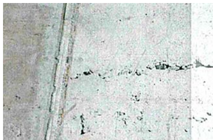
▲ 콘크리트 타설 시 다짐 불량 등으로 재료분리 발생
