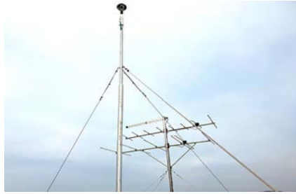
▲ SMATV 안테나 중 DMB 안테나 방향이 다르게 시공
