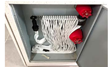
▲ 옥내소화전함 내 호스 및 관창 방수구 연결
