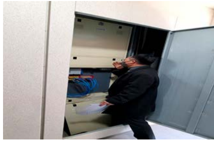
▲ TPS실 깊이가 확보되지 않아 홈네트 워크용 장비 유지관리 공간 확보 부족
