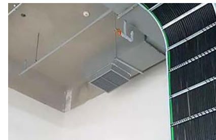
▲ 기계실 천장 S/P 드레인 배관은 바닥 트렌치로 연결시공 필요
