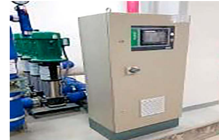
▲ 기계실 각종 장비사용 시 주의사항 및 응급 시 조치사항 등 안내표지 부착 필요
