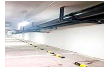
▲ 지하주차장, 기계실 지역난방 고온수 1차 측 배관 누출사고 방지 및 안전을 위하여 위험 표지 부착 필요
