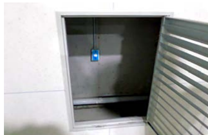
▲ 지하 승강기홀 제습 대책 검토 필요
