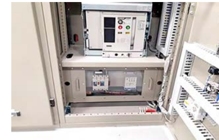
▲ 전기실 수배전반 VCB 내부에 수동 조작봉 미비치
