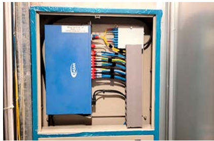
▲ TPS실 홈네트워크 L2 스위치를 겹쳐 시공하여 장비 고장 및 유지관리 어려움
