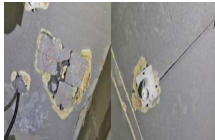
▲ 최상층 세대 천장 단열재 결손부위 및 이음매 충전 부족
