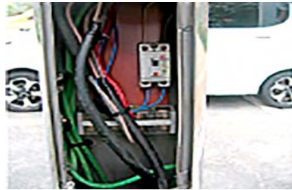
▲ 비방수형 ELB(누전차단기)설치로 보안 등주 내부결로 및 누수로 차단됨
