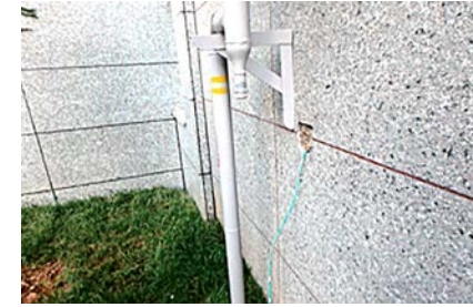
▲ 도시가스 배관 접지 마감 미흡
