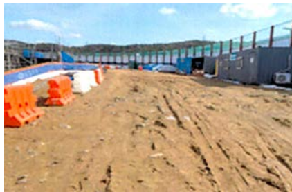
▲ 지반 상태 연약에 따른 침하로 장비 전도 등 안전사고 우려
