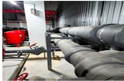
▲ 소화펌프 흡입측 연결배관에 소화배관 표지 부착
