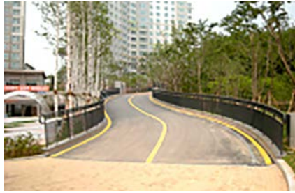
▲ 단지 내 도로 우수 처리 대책 미흡
