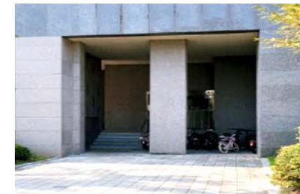
▲ 주 보행동선 필로티 상부 낙하방지 안전시설 설치 미흡
