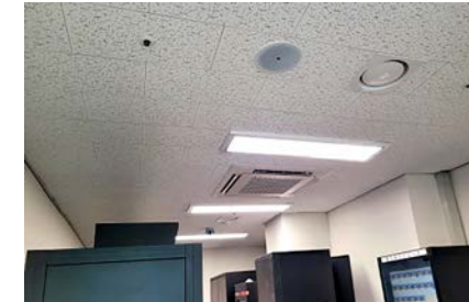
▲ 방재실에 물분무식 소화설비를 구축하여 화재 시 통신장비 안전성 확보 미흡
