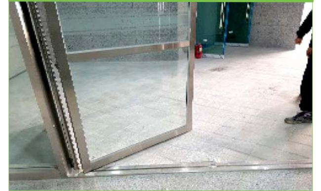
▲ 출입구 방풍실에 기밀 자동문(내부) 및 패닉 오픈 자동문(외부) 설치로 운반 동선 확보 및 비상 대응성 강화
