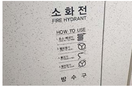
▲ 옥내소화전 사용설명서가 외부에만 표기되어 있음
