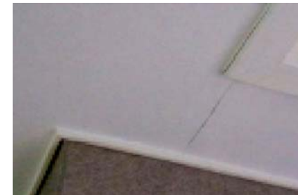
▲ 우물천장 모서리에 석고보드 조인트가 위치하여 도배 터짐 하자 발생
