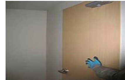
▲ 대피공간에 완강기 미설치(3층~10층)
