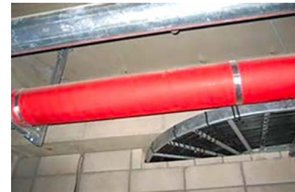
▲ 지하주차장 유수검지장치실 내 점검용 전등 미설치
