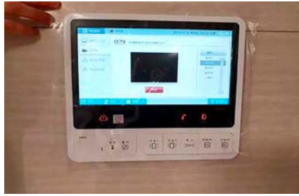
▲ 월패드에 연계된 각종 설비의 세팅 및 동작 상태의 점검 미비
