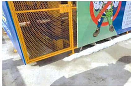
▲ 타워크레인 방호울타리 하부로 우수 침입 우려
