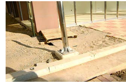
▲ 옥외 보안등 볼트 체결 부위 보호를 위한 하부 안전 커버 미설치
