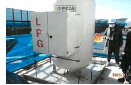
▲ 가설 식당 옆 LPG 저장소 출입제한 시설 설치 필요
