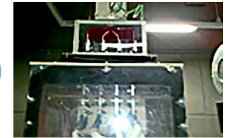
▲ 발전기실 버스덕트 상·하부에 점검용 아크릴판 부착
