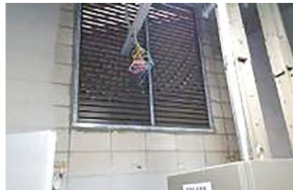
▲ 발전기실 기동용 급기 그릴에 동절기 냉기 유입 방지 어려움
