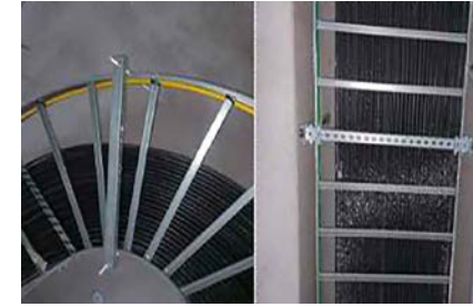
▲ 트레이 전산볼트 하부 캡 설치 및 이물질 제거 필요
