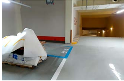
▲ 시거제약 부분에 주차공간이 위치하여 주정차 차량과 주행차량 사고 위험
