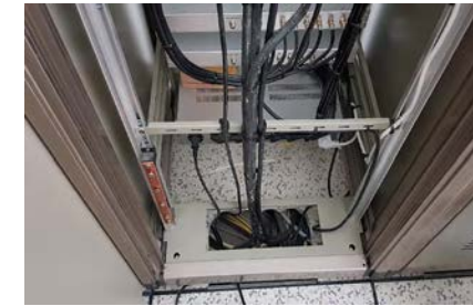
▲ 각 랙에 접지선 시공 및 각 장비와 접지선 미시공
