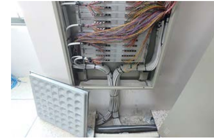
▲ 각종 랙부위 접지누락 보완 및 케이블 정리 필요
