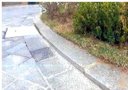
▲ 경계석 설치 불량으로 단차 발생
