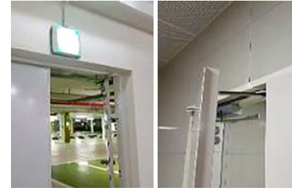
▲ 지하층 승강기홀·기계실·전기실 등에 설치된 양개도어에 도어클로저 및 개폐 순위조절기 미설치
