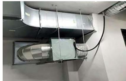
▲ 지하 방재실 덕트인라인팬 진동방지 조치 필요
