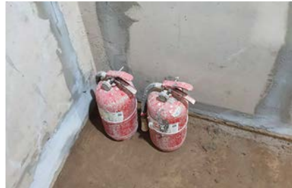
▲ 건설현장 임시소방시설용 소화기 관리 불량
