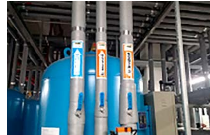
▲ 기계실 각종 배관 용도 및 배관 물흐름 방향 표기
