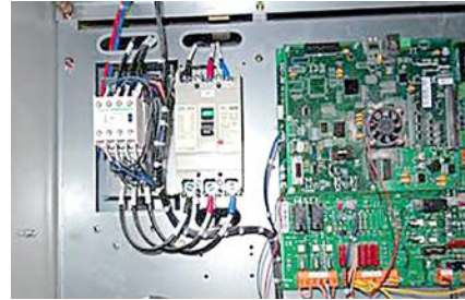
▲ 승강기 기계실 제어반 서지보호장치(SPD) 설치 필요
