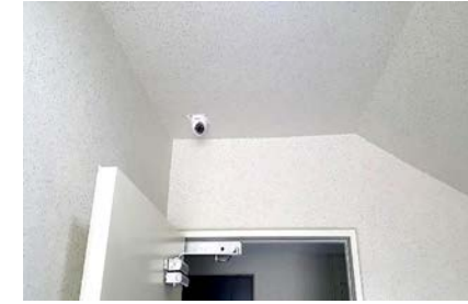
▲ 개인정보 보호법에 따른 CCTV 설치 안내판 미부착
