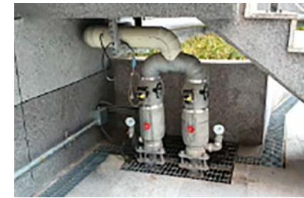
▲ 선큰 등 옥외에 설치된 집수정 배관의 동파방지 조치 미흡
