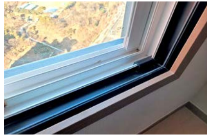
▲ 코킹 시공 불량 시 창호 프레임 하부 틈으로 물 침투 우려
