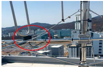
▲ 안테나와 피뢰침 고정 지지선이 혼촉되어 방송신호 수신 시 잡음 발생
