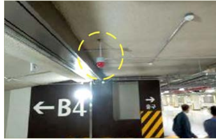
▲ 지하주차장 램프 경광등 위치상 시인성 부족
