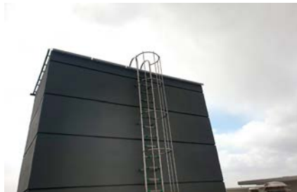
▲ 옥탑 점검용 사다리 피뢰도선 미접지
