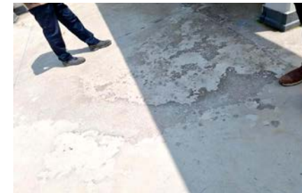
▲ 옥상 바닥 누름콘크리트 박리현상 부분 보완 필요
