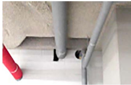
▲ 지하주차장 내 방화구획 관통 부위 마감 미흡
