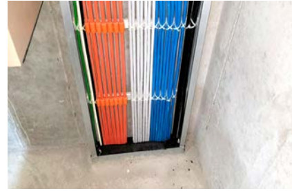
▲ TPS실의 통신 트레이 및 케이블 마감 상태와 청소상태 양호
