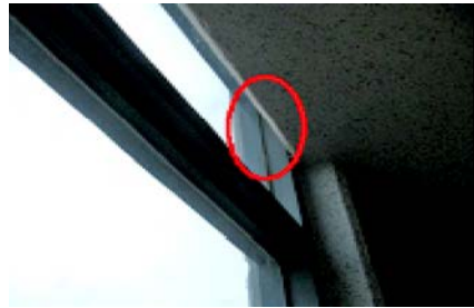
▲ 계단실 창호와 슬래브 간섭부위 코킹 누락
