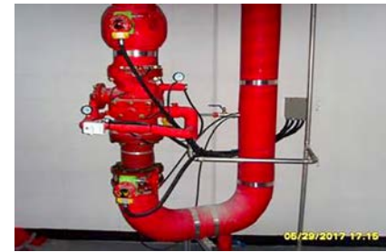
▲ 지하주차장 S/P 프리액션밸브 방호구역 표지 미설치요
