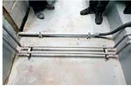
▲ 발전기실 통행동선 내 급유배관 설치로 파손 우려
