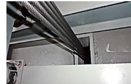
▲ 승강기 기계실 승강기 인양 로프 인출구 소음 방지판 미설치
