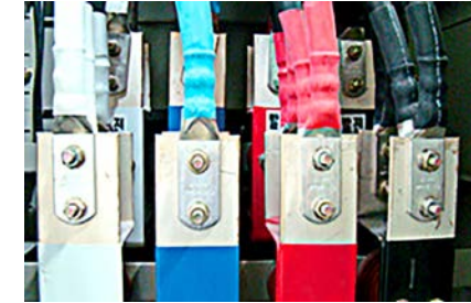
▲ 저압반 버스바(Bus Bar) 연결 볼트/너트 마킹 처리 미흡
