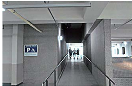
▲ 지하주차장 출입구 측면 보행통로 조도 추가 확보 필요
