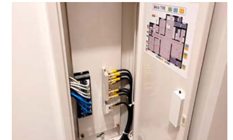
▲ 세대 통신단자함을 규정보다 넓게 시공하여 사용자 용이성 확보
