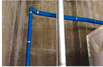
▲ 소화수조 급수배관에 수격방지기 설치 필요
