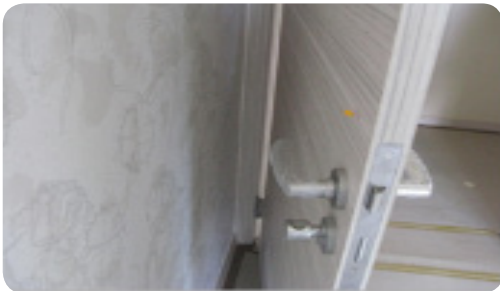
- 출입문 개폐 시 손잡이 및 벽체 파손 우려
