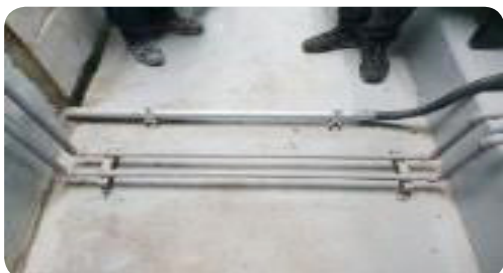
-발전기실 통행 동선 내 급유배관 설치로 파손 우려
