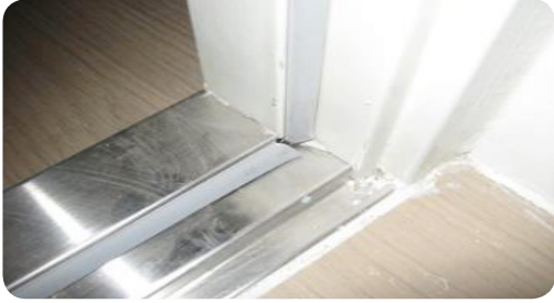
- 방화문 개스킷 설치 부적정
