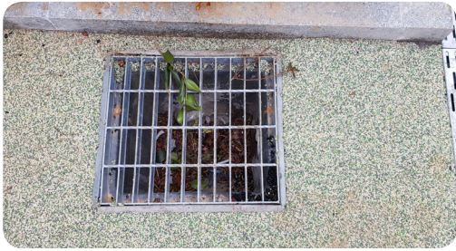
- 집수구(정) 뚜껑 하부에 필히 거름망 설치 필요
