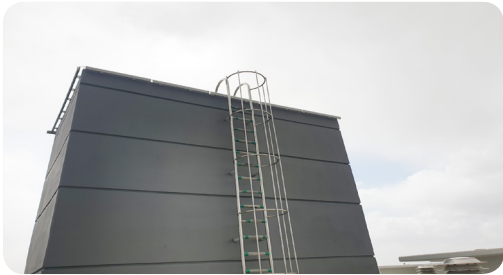
- 옥탑 점검용 사다리 피뢰도선에 접지 바람
