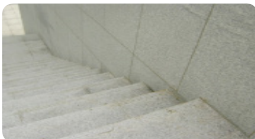
- 단지 내 광폭 계단의 핸드레일 미설치
