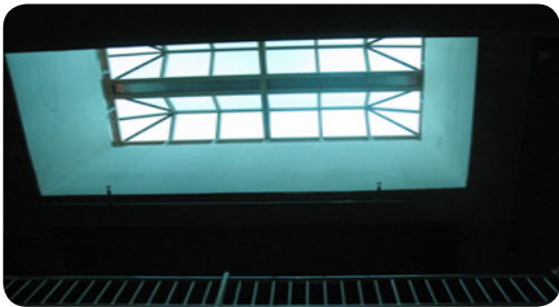
- 지하주차장 자연채광 도입 부분 안전시설 미흡
