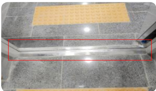
- 지하 승강기홀 주차장 출입문 하부 문틀 보양 필요
