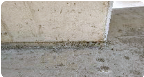
- 기둥 하부 재료분리로 인한 단면 손실부는 기둥과 동일한 강도의 무수축모르타르로 보강 바람
