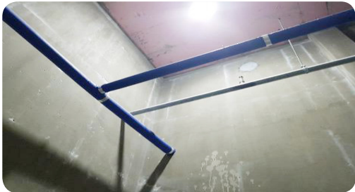
- 조경용 배관의 퇴수배관 및 밸브 높이가 높아 유지 관리 불편
