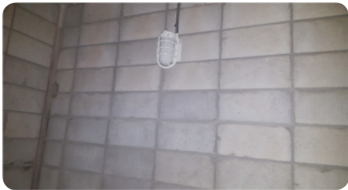
- 유수검지 장치실 점검용 전등 설치
