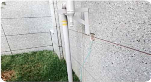
- 도시가스 배관 접지 마감 미흡
