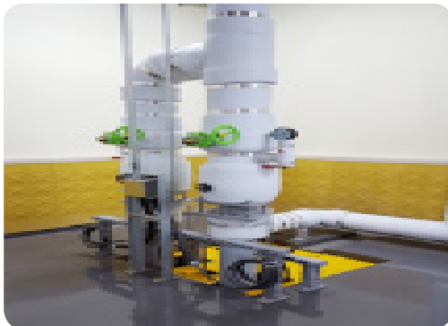
- 영구 배수 집수정 배수 상태 확인 및 관리 필요
