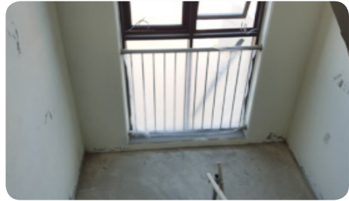
- 계단참 하부 안전난간 설치 (하부 유리가 접합 안전유리면 불필요)
