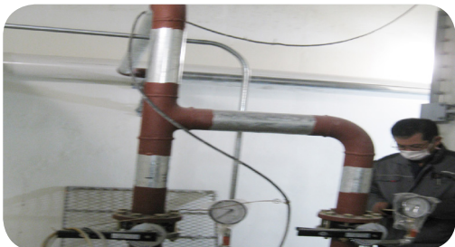
- 지하층 배수펌프 배관 여름철 결로 발생 조치 필요
