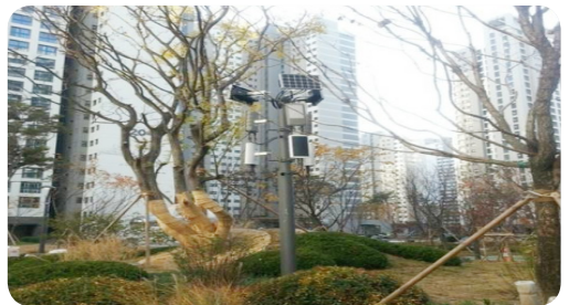
- 옥외 이동통신 안테나를 가로등 일체형으로 통합하여 위장 시공
