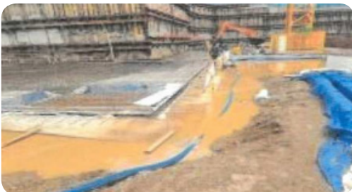
- 작업장 주변 가배수로 설치 필요
