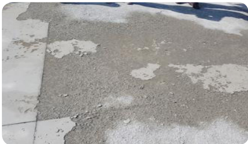
- 옥상 바닥 누름콘크리트 박리현상 부분 보완 필요
