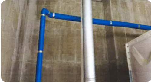
- 소화수조 급수배관에 수격 방지기 설치 필요
