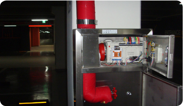
- 지하주차장 소화전 번호 라벨 부착하여 유지관리 효율성 제고 우수
