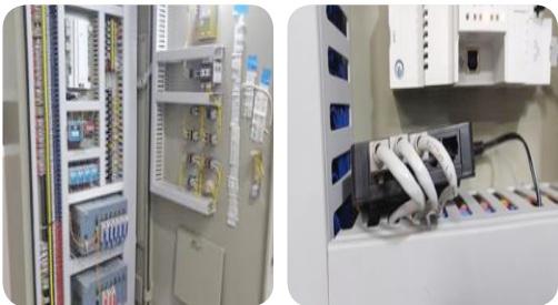
- 기계실 MCC 반 입출력 리스트 미비치 및 수위계·허브 연결 단지 용도 미표기
