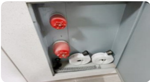
- 옥내 소화전함 내 호스 및 관창 방수구 미연결
