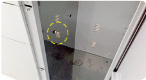
- 대형 보관함에 비상탈출 버튼 설치
