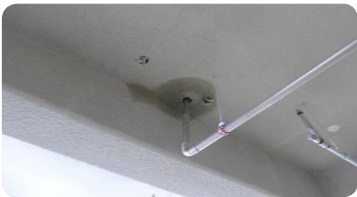
- 지하주차장 배관 관통 부위 누수 발생
