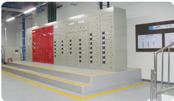
- 기계실 침수방지를 위하여 MCC 반 높이 설치 우수
