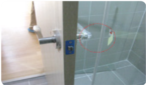
- 욕실 출입문 개폐 시 샤워부스 간섭되어 파손 우려
