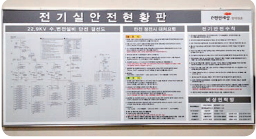
- 전기실 준공 표지판 부착(단상 결선도, 안전 수칙 및 비상 연락망 포함)
