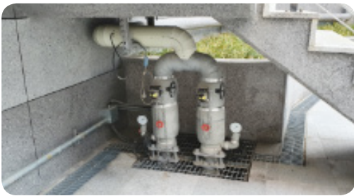
- 선큰 등 옥외에 설치된 집수정 배관의 동파방지 조치 미흡
