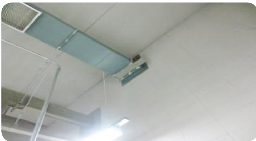
- 방화댐퍼 설치 부위 점검구 설치 필요
