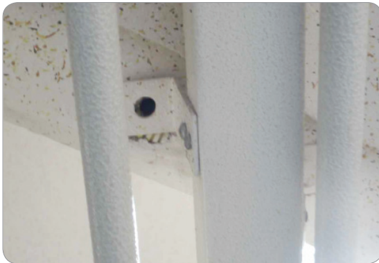
계단실 난간 볼트 탈락에 의한 고정불량
