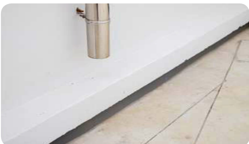
- 옥상 옥탑 배수를 위한 선홍통 하부 빗물받이 미설치
