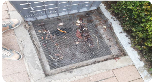
- 모기, 쓰레기, 낙엽 투입 방지시설(이중거름망 설치)
