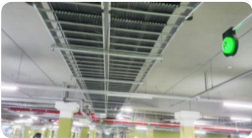
- 전기 트레이에 의해 스프링클러의 살수 장애가 발생 되지 않도록 조치
