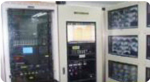
- 방재실 화재수신기 오작동 부분 점검 및 보완 필요
