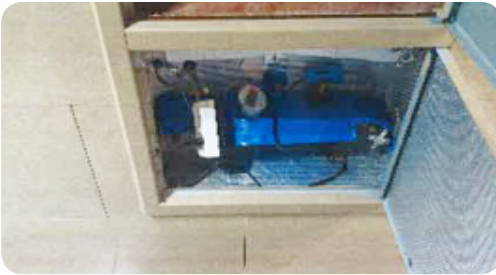
- 수도계량기 동파방지 열선의 전기 콘센트는 누수 시 감전 위험 있음
