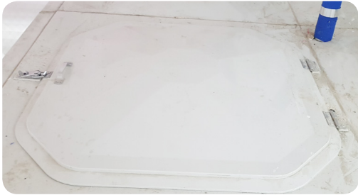
-저수조 상부 맨홀턱 높이가 낮아 물청소 시 먼지, 오물 등 내부 유입
