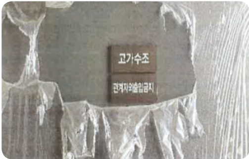
- 소화수조실이 고가수조실로 표기됨
