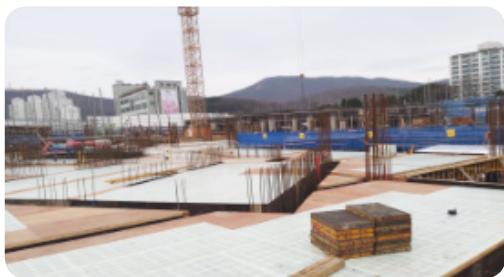
- 타워크레인 방호선반 미설치
