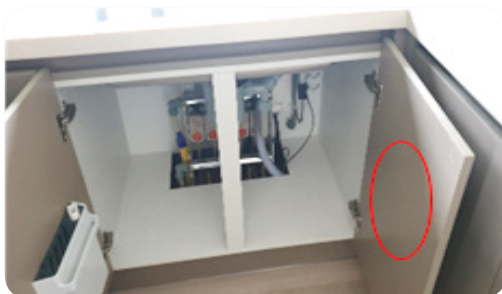
- 싱크대 하부 온수분배기의 난방 구획도 누락
