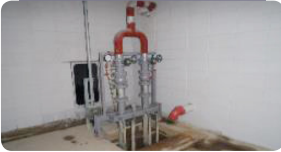
기계실로 오버플로우관 유도, 침수우려 有
