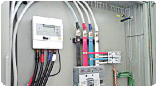
- 승강기 기계실 분전반 전력량계 미설치
