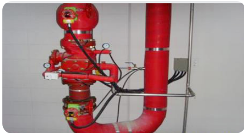
- 지하주차장 스프링클러 프리 액션밸브 방호구역 표지 미설치
