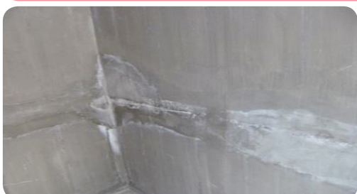
- 조인트 누수로 인한 백화 제거 필요
