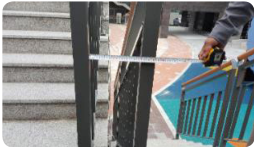
- 외부 계단 난간 틈새가 넓어 유아 및 어린이 끼임 사고 우려
