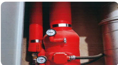
- 공용 복도에 위치한 알람벨브에 사용설명서 미비치
