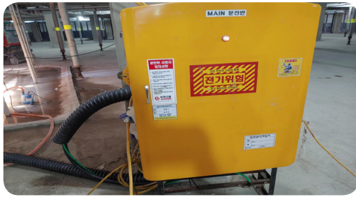
- 분전반 시건장치 설치 필요
