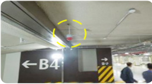
- 지하주차장 램프 경광등 위치상 시인성 부족
