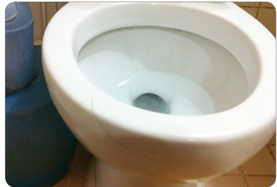
양변기 균열(10%이상 세대)
