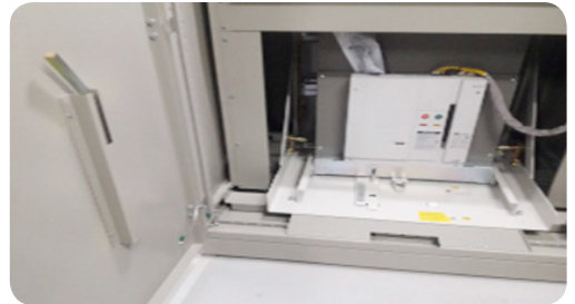
- 전기실 수배전반 VCB 수동조작봉 내부 수납 비치
