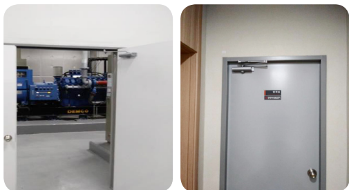
- 발전기실 및 방재실의 갑종방화문에는 도어클로저 설치
