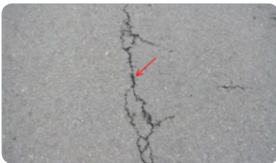
단지내 아스콘 균열
