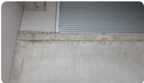
- 발전기실 장비반입구 마감 처리 미흡
