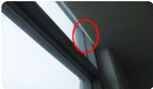
- 계단실 창호와 슬래브 간섭 부위 코킹 누락
