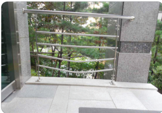
외부계단 안전난간 파손
