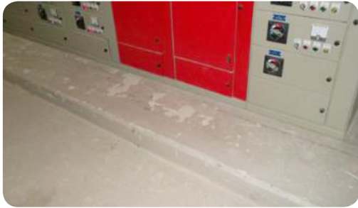
- 전기실·기계실 바닥 마감 처리 미흡
