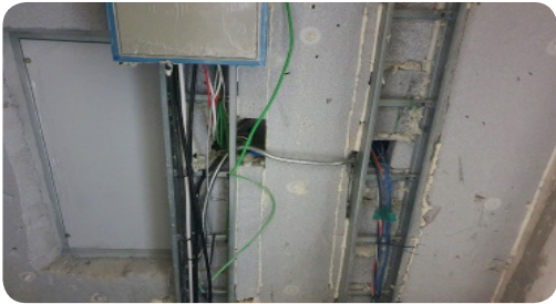
- TPS실의 통신케이블의 시공 및 청소상태 미흡
