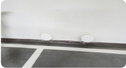
- 지하주차장으로 유도한 넘침관으로 물 넘침 시 비상연락처를 미기재하여 신속 대응 어려움
