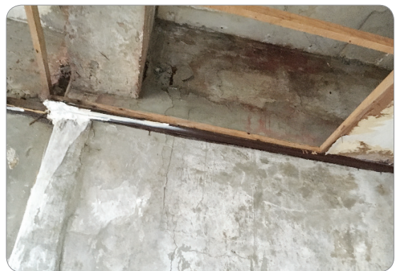
누수로 인한 콘크리트 내부 철근 부식
