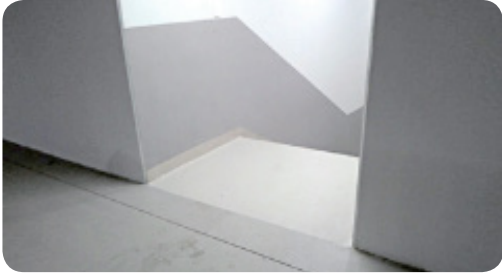
- 지하주차장 침수 시 전기실 물 유입 우려
