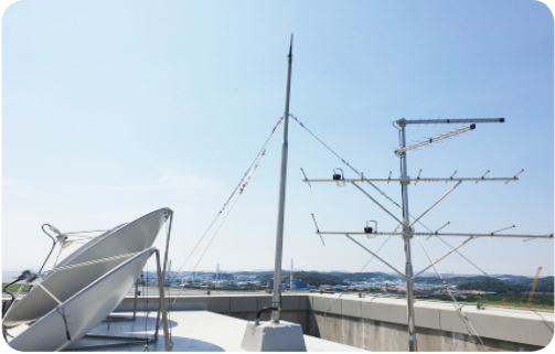
- 옥상 TV안테나와 피뢰설비 간 이격거리 부족과 피뢰설비 높이 미비
