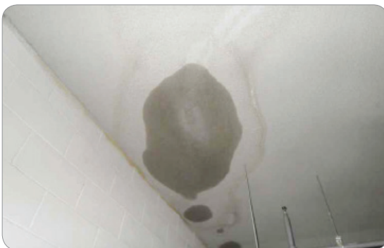
지하주차장 벽체 누수(균열하자)
