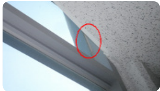
- 창틀 상부 코킹 누락 부분 보완
