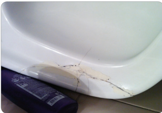
세면기 균열(깨짐)(10%이상 세대)
