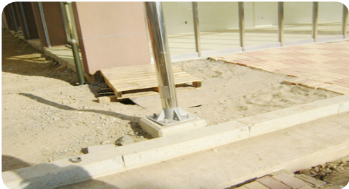
- 옥외 보안등 볼트 체결 부위 보호를 위한 하부 안전 커버 미설치
