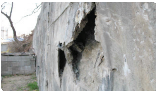
옹벽 파손 및 손상
