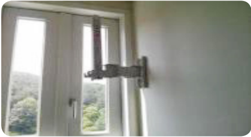
- 세대 대피공간 완강기 거치대 사용설명서 벽체에 확대 부착 및 입주민에게 사용방법 안내 바람
