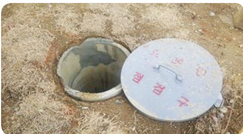
- 녹지대 수직 우수 드레인 및 각종 점검구 잠금장치 미설치로 어린이 등 안전사고 우려
