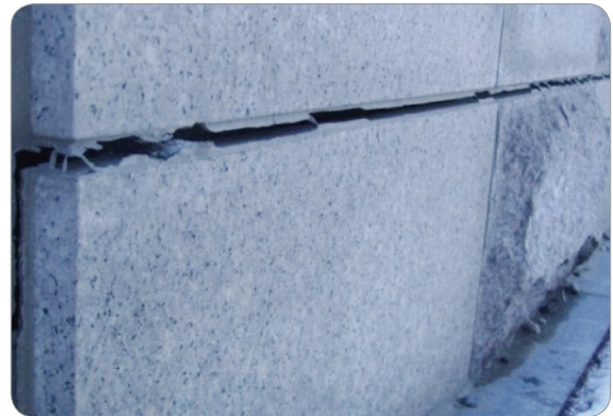
대리석의 패턴화된 탈락
