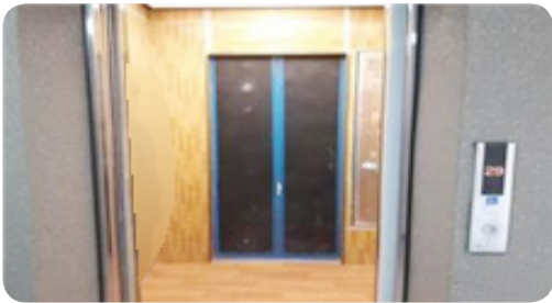
- 양방향 출입 구조 승강기의 경우, 승강기문 앞쪽과 뒤쪽에 주의 표지판 부착 및 안내방송 등으로 출입 방향 고지필요
