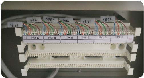
- 전화, 네트워크 등 각 케이블에 세대 동·호수를 표기 라벨을 보완
