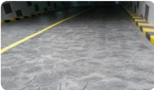
- 지하주차장 램프 바닥 표면 강화 코팅 확인 필요
