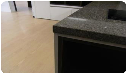
-주방 아일랜드 식탁, 싱크대 상판 등 석재 모서리 안전사고 우려
