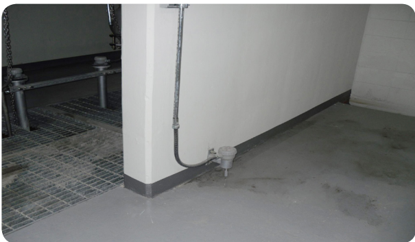
- 기계실 침수방지 센서 설치 우수
