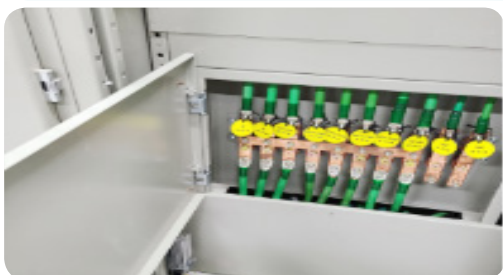
- 접지단자함 내 접지저항 측정 기록표 미부착
