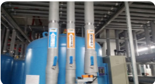
- 기계실 각종 배관 용도 및 배관 물 흐름 방향 표기
