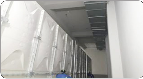
- 저수조실 내 조명 미설치
