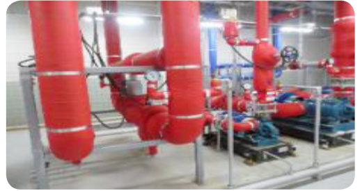
- 균압 방지용 릴리프밸브 설치
