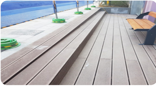
- 부대시설 보도 단차로 인한 턱걸림 안전사고 우려
