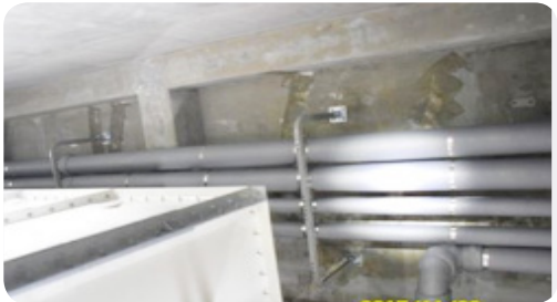
-저수조 상단 오염원(배수 배관) 낙수 예방 조치 필요
