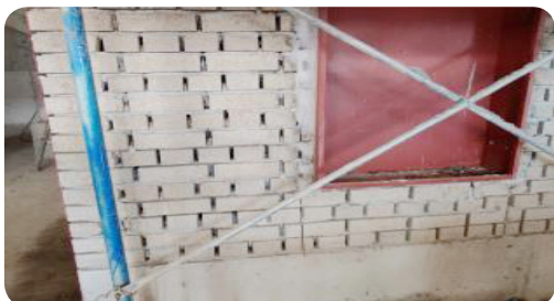
- 조적 벽체 내 배관 매입부분 사춤 부족
