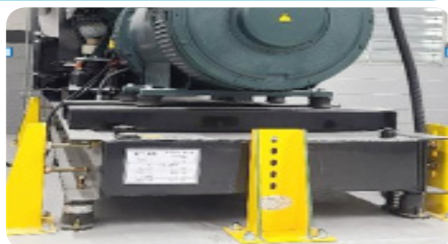
-비상발전기의 내진스토퍼 추가 설치
