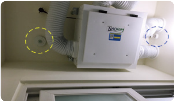
- 실외기실에 스프링클러 및 화재감지기 설치 우수
