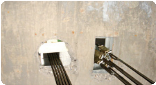
- 승강기 기계실 바닥 하부 마감 불량
