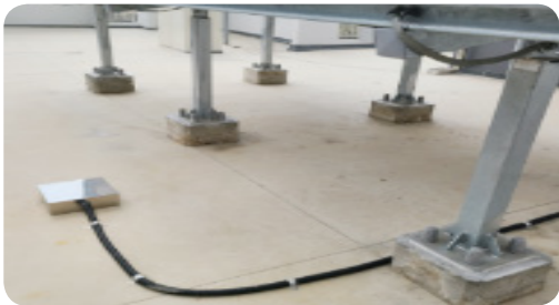
- 태양광 배관 보호 마감 및 강제 전선관으로 시공 필요
