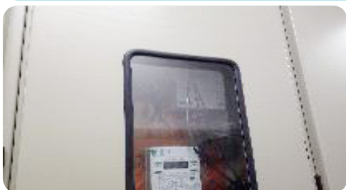
- 전기실 내 계량기 중 주택용이 아닌 계량기는 주택 용과 구분될 수 있도록 계량기 및 배전반 외면에 용도 표기 필요
