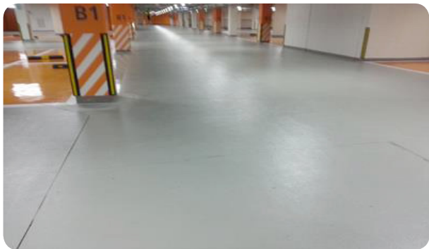
- 지하주차장 차량 통로 구간 엠보싱 처리 우수
