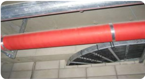
- 지하주차장 유수검지 장치실 내 점검용 전등 미설치
