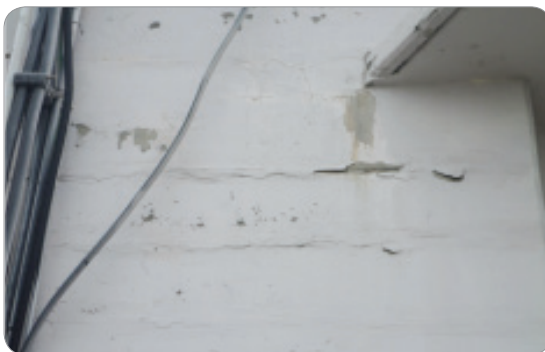
철근 길이방향 균열
