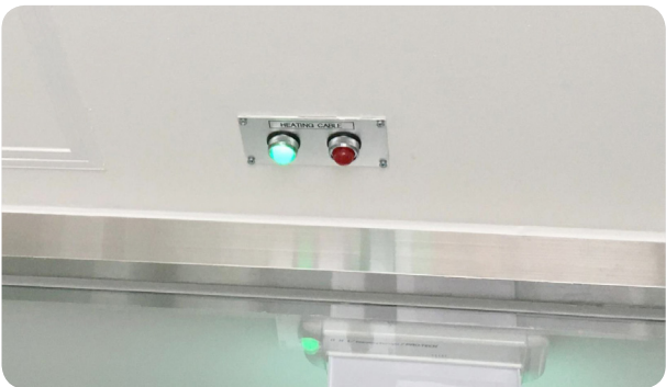
- 동파방지 열선 및 관리주체에서 램프 작동 여부 확인 가능토록 램프 시공 우수
