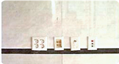
- 전기 콘센트 설치 수평 불량
