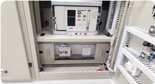
- 전기실 수배전반 VCB 내부에 수동조작봉 미비치
