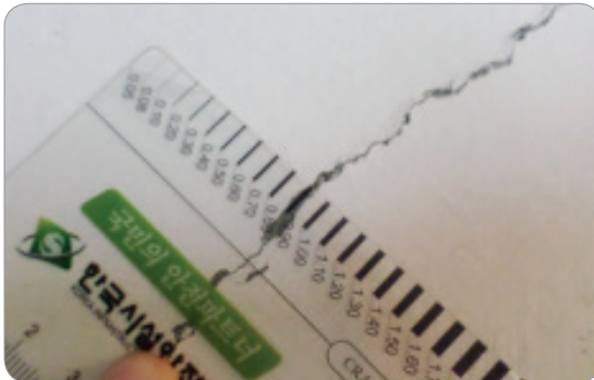
구조부의 균열 폭 0.3mm 이상 균열
