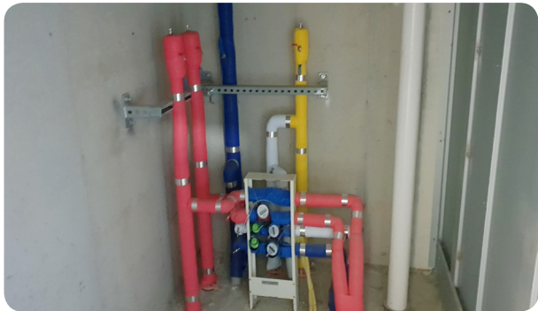
- 세대 전실 PD 내 계량기 통합 설치 양호
