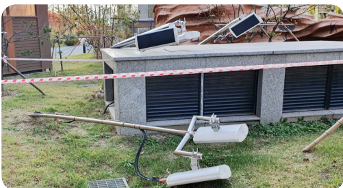
- 옥외 이동통신 안테나 강도 계산 부족으로 강풍에 의한 전도 및 파손 발생
