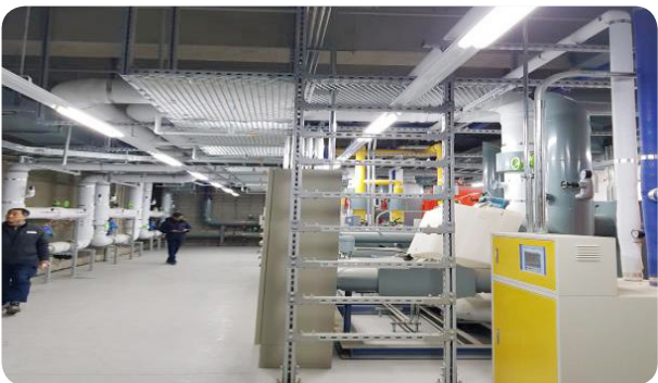
- 유지관리를 위한 캐트웨이(Cat way) 설치 우수
