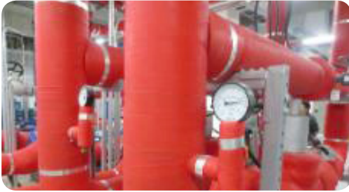
- 일반형 감압밸브 사용 시 균압방지용 릴리프밸브 미설치
