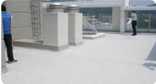
- 옥상 누름콘크리트 커팅 부분 코킹 처리 미흡
