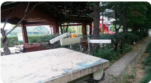
- 옥외 이동통신 안테나가 노출되어 미관 저해 및 위험성 초래
