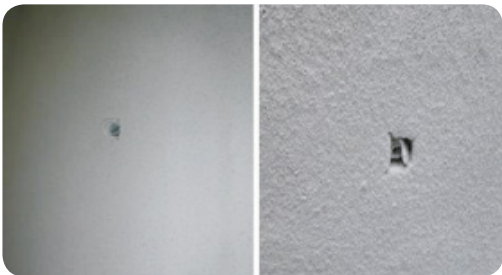
- 계단실, 복도 등 공용부위 불필요한 전기·설비 박스 마감 보완
