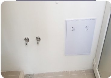
수전인접 설치 지양
