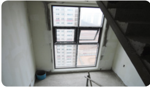
- 계단참 하부 유리 부분 안전난간 설치 필요
