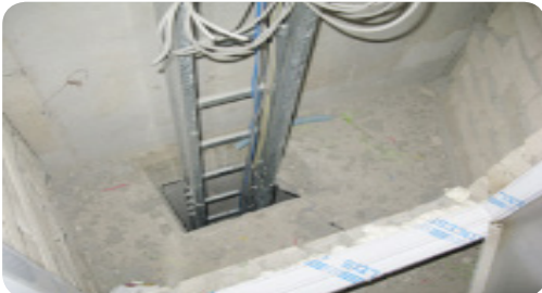
- 방화구획에 해당되는 벽체 및 바닥 관통 부위 발생, 방화구획 미인정
