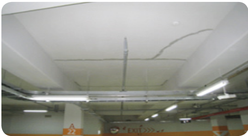
- 지하주차장 천장 슬래브 균열
