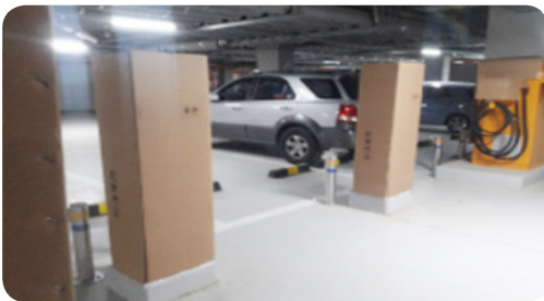
- 지하주차장 전기자동차 충전 전용 분전함 내에 전자식 전력량계 미설치(한전 계량기 별도 설치 필요)
