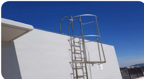
- 옥탑 사다리 등받이 간살 추가 설치 필요
