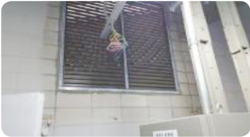
- 발전기실 기동용 급기 그릴에 동절기 냉기유입 방지 어려움
