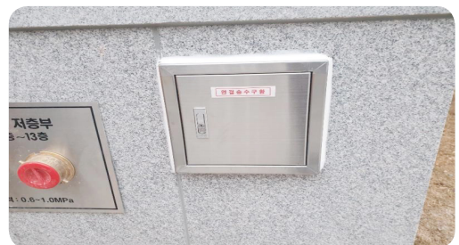
- 옥외 연결송수구 펌프용 기동스위치함 주변 코킹 시공하여 우수로 인한 고장 예방(또는 방수형으로 교체)
