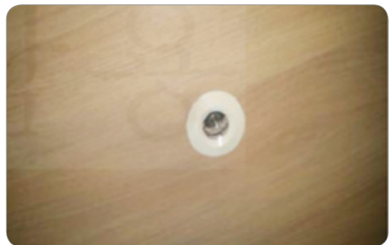
천장 처짐에 의한 스프링클러 내부 인입
