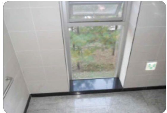
계단실 안전난간 미설치(시공현황)
