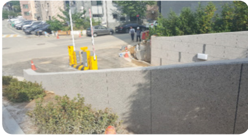
- 주차장 램프 상단 난간 높이(1.2m) 기준 미달 안전 사고 우려
