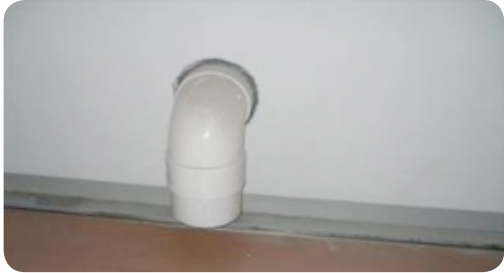
- 지하주차장으로 유도한 넘침관은 말단에 해충 침입 방지망 미설치 및 주차공간과 접한 오버플로우관의 경우, 배기가스 유입 방지 어려움
