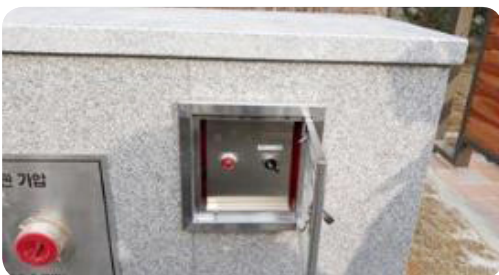
- 옥외 연결송수구 펌프용 기동스위치함 프레임에 우수유입방지 미흡
