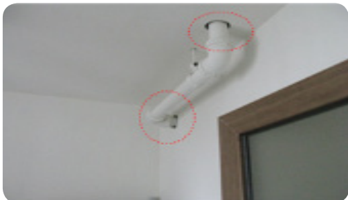
- 발코니 배수관 주변 마감 처리 미흡
