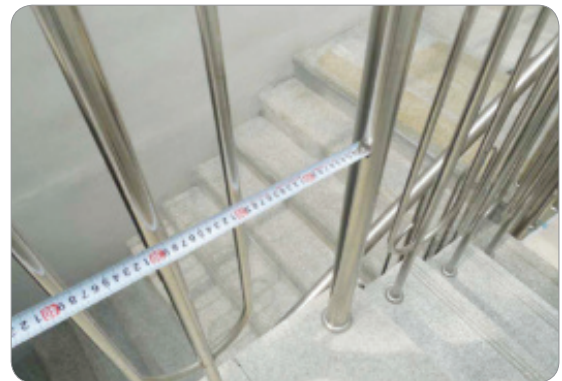
계단실 안전난간 간살간격 초과시공
