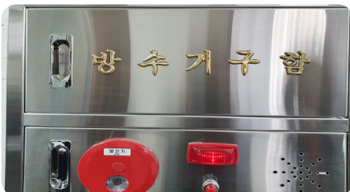
- 방수기구함의 표식은 축광식으로 설치
