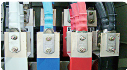
- 저압반 버스바(Bus Bar) 연결 볼트/너트 매직 마킹 처리 미흡
