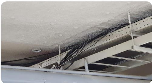
- Tray 위의 적정공간을 확보하지 못해 케이블이 Tray를 이탈하여 시공
