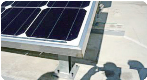
- 태양광 발전시스템 날카로운 모서리 마감 처리 필요
