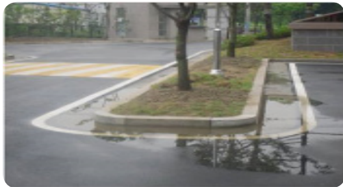
-측구 및 포장구배 불량으로 물고임 발생
