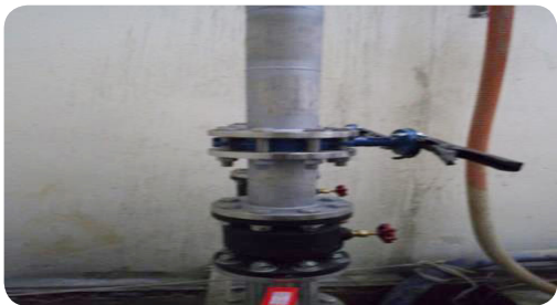
- 빗물저류조 배수 배관 절연 시공 필요
