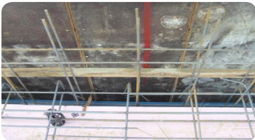
- 슬래브 상부근의 외벽 피복 위치까지 도달 못함
