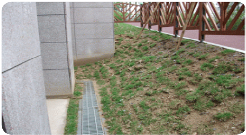
- 우수가 건물 쪽으로 유입되면서 조경토 유실로 트렌치 막힘 우려
