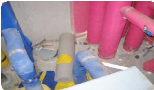
- 승강기홀 PD, EPS, TPS실 내부 청소상태 미흡
