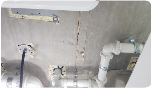
- 최상층 세대 욕실 천장 단열재 결손 부위 마감 처리 미흡
