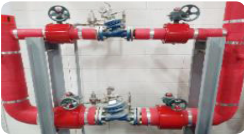
- 기계실 감압밸브 유지관리 및 점검이 쉽도록 1,2차 측에 설정 압력 표지 부착하기 바람
