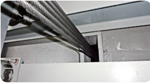
- 승강기 기계실 승강기 인양 로프 인출구 소음방지판 미설치
