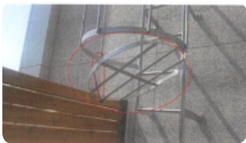
- 옥탑 점검 사다리 시건장치 미설치
