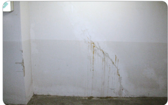
누수를 동반한 균열
