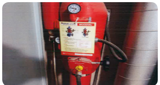
- 공용 복도에 위치한 알람벨브에 사용설명서 비치
