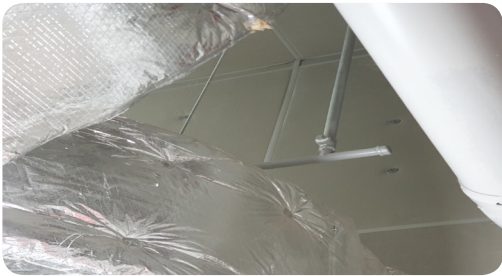
- 스프링클러 교차 배관 및 가지배관 말단부에 내진 버팀대 설치 필요
