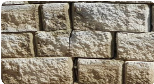
- 보강토 옹벽 블록 균열 발생
