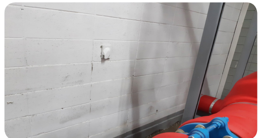
- 기계실 내 장비 인접 콘센트 방적형으로 설치
