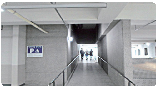
- 지하주차장 출입구 측면 보행통로 조도 추가 확보 필요
