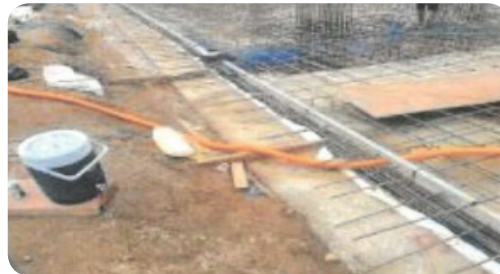
- 철근 위 근로자 안전통로 미확보
