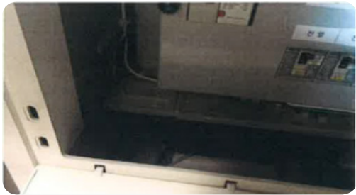
- 전기 분전반과 통신 단자함 동일 공간에 설치 시 사이에 격벽 설치 등 분리 조치
