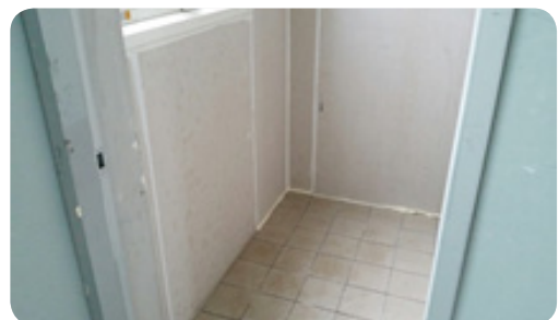
- 발코니 결로방지를 위한 단열재 및 CRC 보드 등 추가 시공 권장 - 결로방지용 벽체 설치 시 하부 바닥면과 틈새 밀실 시공
