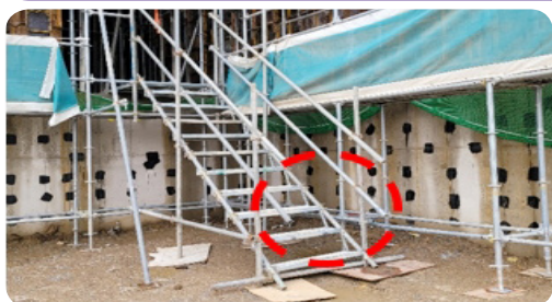
- 가설 계단 난간 손잡이 단부에 보호캡 설치 필요
