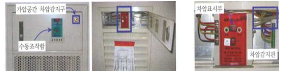
자동차압. 고압조절형 댐퍼 수동조작함
