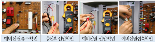
예비전원퓨즈확인 충전부 전압확인 예비전원 전압확인 예비전원접속확인
